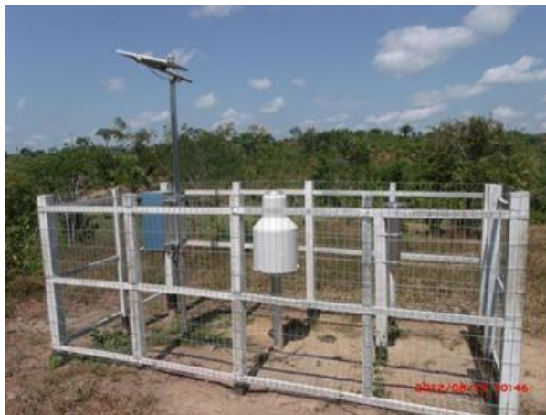
Figura 11.2 - 4 - Estação Pluviométrica/ Pluviográfica do Igarapé Cobal- Observar a instalação de Pluviômetro, Pluviógrafo e da PCD.
