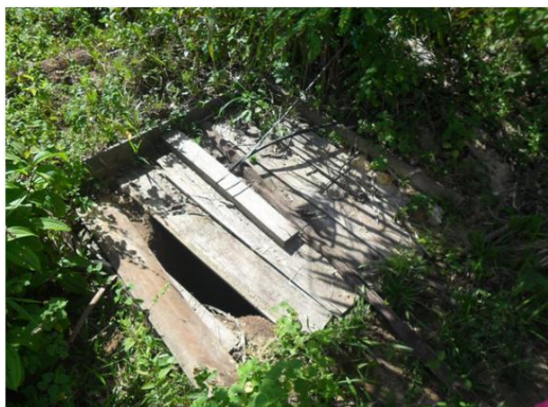
Figura 11.2 - 63 - Poço com bomba submersa, coberto com madeira
