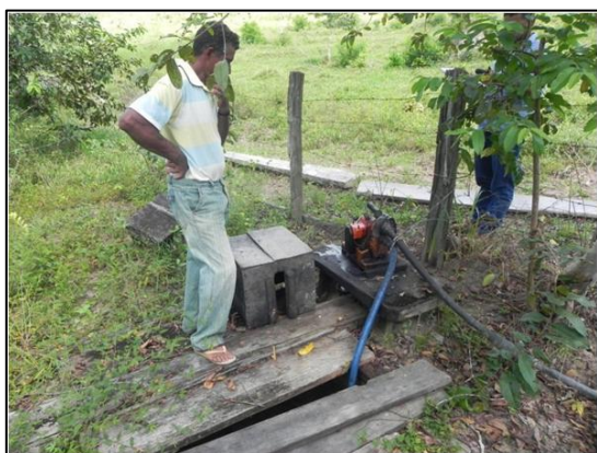
Figura 11.2 - 61 - Poço com motor bomba e coberto com taboas que abastece a residência do Sr. Manoel Felix Santos
