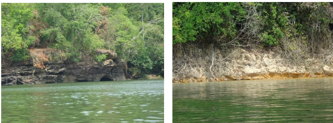
Figura 10.3 - 7 – Erosão desenvolvida pela ação de ondas no pé do talude. O processo poderá evoluir para queda de blocos caso a erosão da base do talude não seja contida
