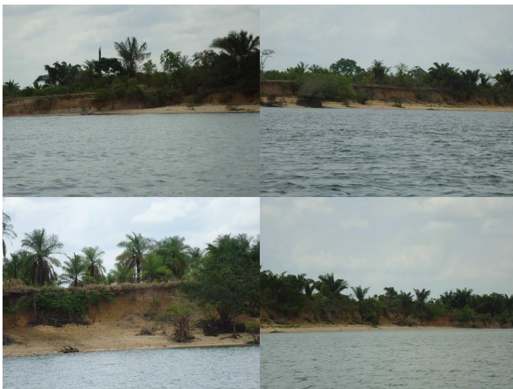
Figura 10.3 - 9 – Barranco de rio na margem esquerda e a jusante do canal de saída onde se observa o processo geotécnico de erosão já plenamente instalado pela natural variação da maré do rio, aliada à degradação da APP pela remoção de vegetação natural lindeira para implantação de pastagem. Coordenadas: Inicial 366.773/9.679.592 a Final 395.504/9.690.606.
