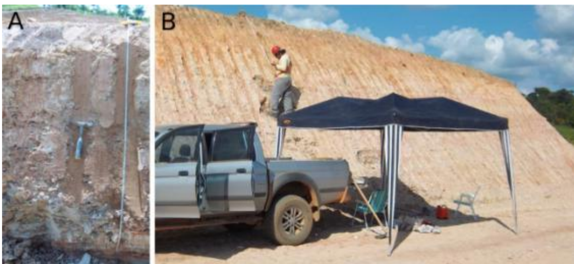
Figura 16 - Talude de rocha dos pontos C1P4 (A; base) e C1P5 (B; topo), descritos na coluna 3.
