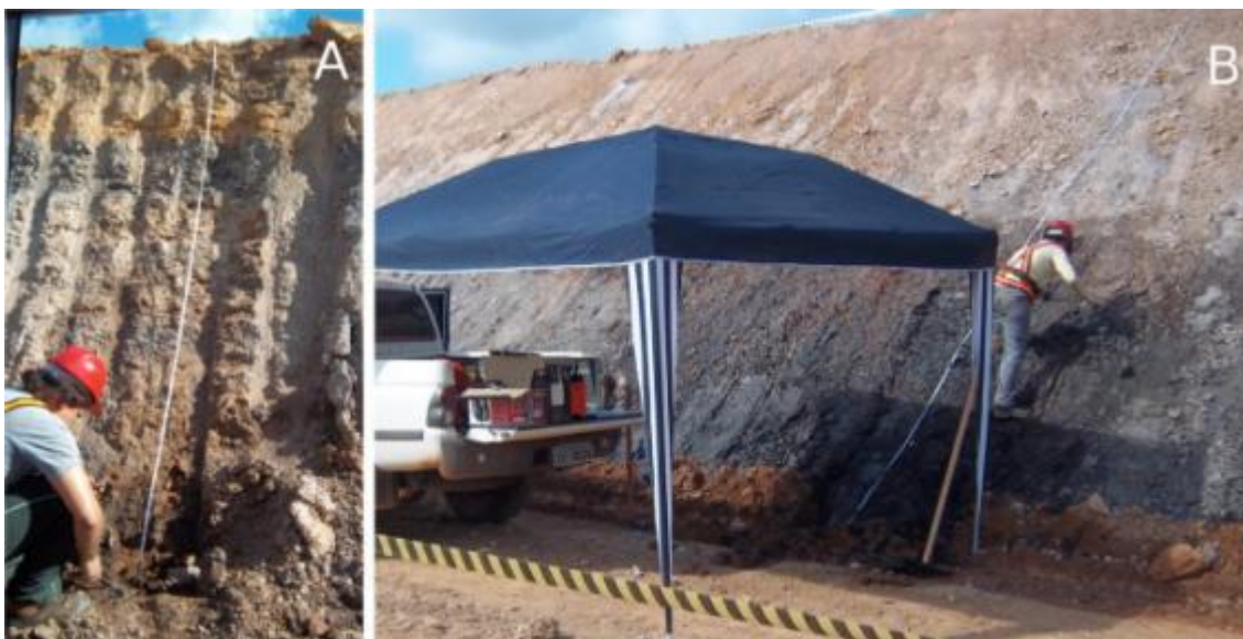
Figura 14 - Taludes de rocha dos pontos C1P1 (A; base) e C1P2 (B; topo), descritos na coluna 1.
