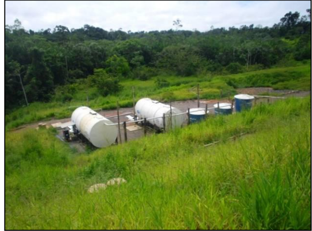
Figura 3.1 - 54 - ETE Sítio Canais e Diques com capacidade nominal de 120 m 3 /dia
