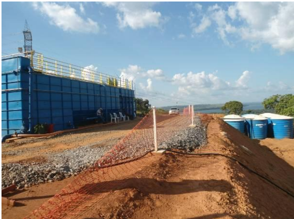
Figura 3.1 - 41 - ETA Sítio Belo Monte com capacidade de 100 m 3 /hora
