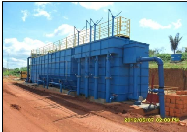
Figura 3.1 - 42 - ETA Sítio Belo Monte com capacidade de 100 m 3 /hora
