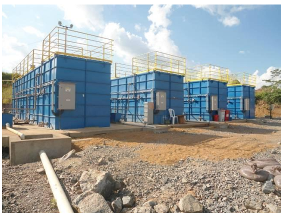
Figura 3.1 - 51 - ETE Sítio Belo Monte com capacidade nominal de 240 m 3 /dia
