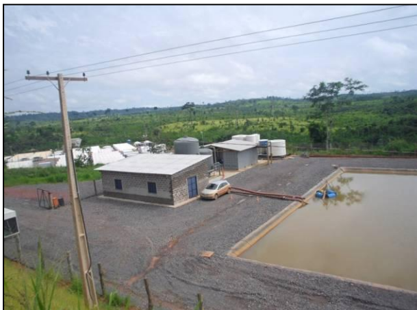
Figura 3.1 - 45 – Vista Geral da Instalação da ETA Sítio Canais e Diques com capacidade de 100 m 3 /hora
