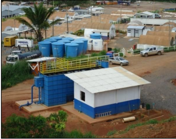
Figura 3.1 - 39 - ETA Sítio Belo Monte com capacidade instalada de 35 m 3 /hora
