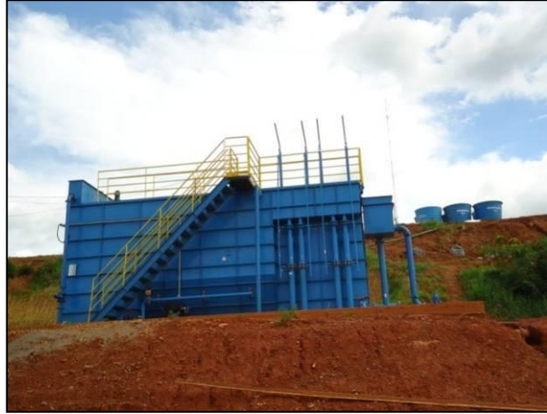
Figura 3.1 - 40 - ETA Sítio Belo Monte com capacidade instalada de 35 m 3 /hora
