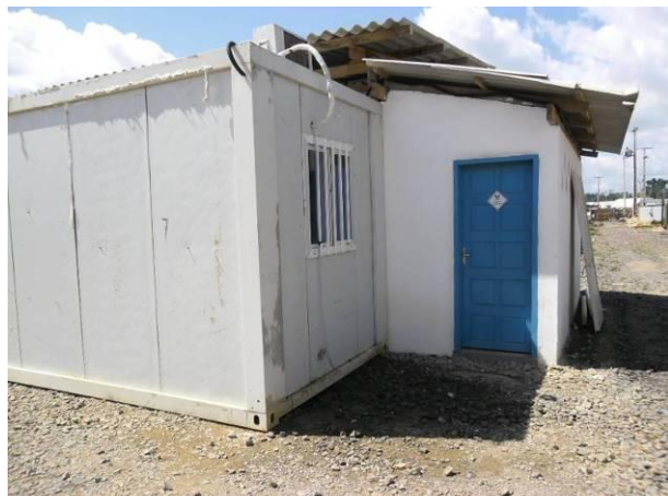
Figura 3.1 - 79 – Local de armazenamento de Resíduos de Serviço de Saúde do Sítio Canais e Diques
