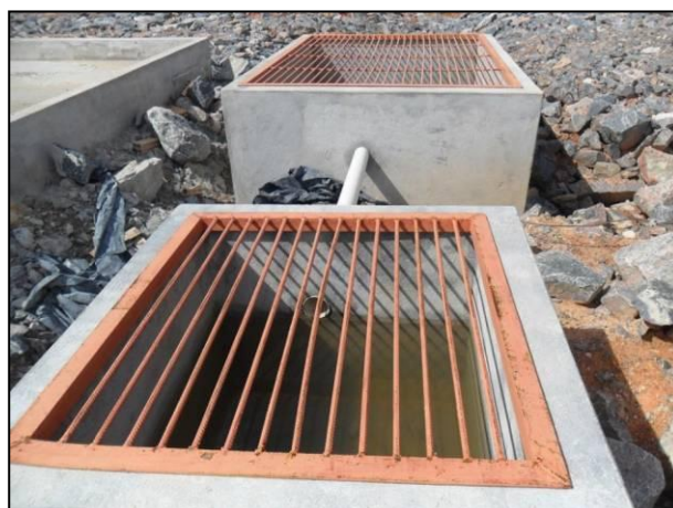
Figura 3.1 - 58 - Caixa separadora de água e óleo Sítio Belo Monte
