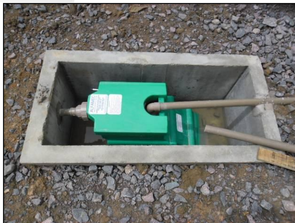
Figura 3.1 - 60 - Caixa separadora de água e óleo Sítio Canais e Diques
