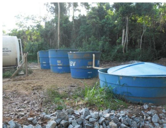
Figura 3.1 - 50 - ETE Sítio Pimental com capacidade de 40 m 3 /dia
