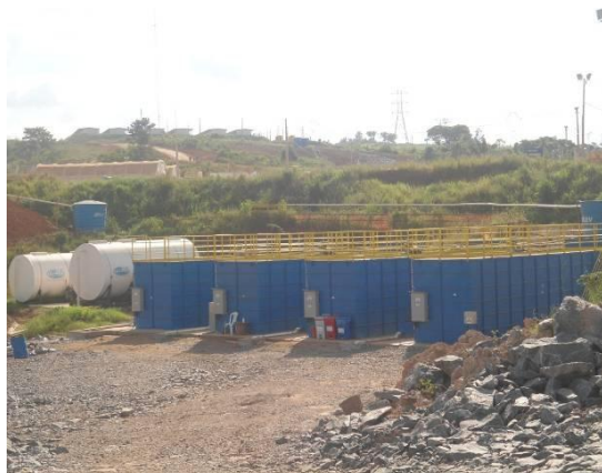
Figura 3.1 - 52 - ETE Sítio Belo Monte com capacidade nominal de 240 m 3 /dia
