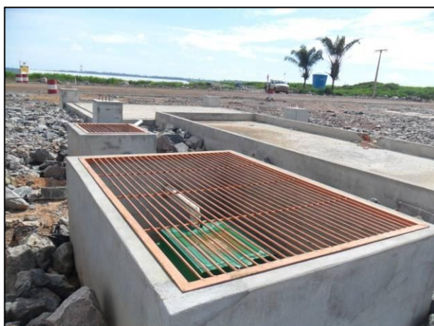
Figura 3.1 - 57 - Caixa separadora de água e óleo Sítio Belo Monte
