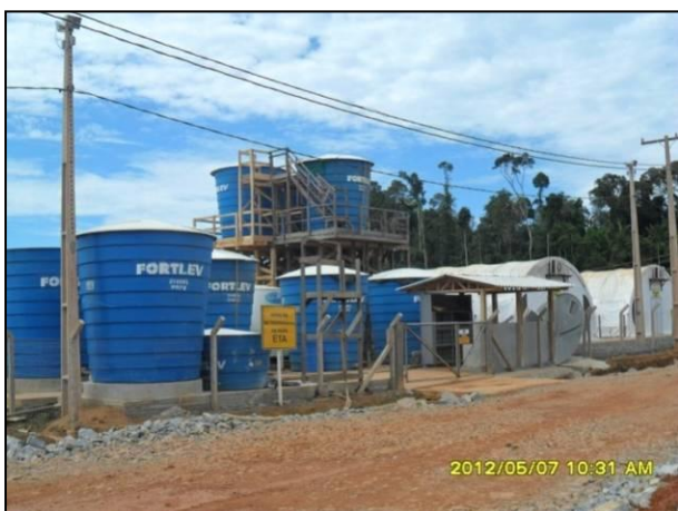
Figura 3.1 - 47 - Instalação da ETA Sítio Pimental com capacidade de 10 m 3 /hora
