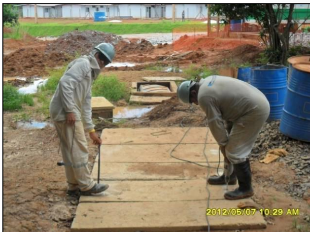
Figura 3.1 - 59 - Caixa separadora de água e óleo Sítio Pimental
