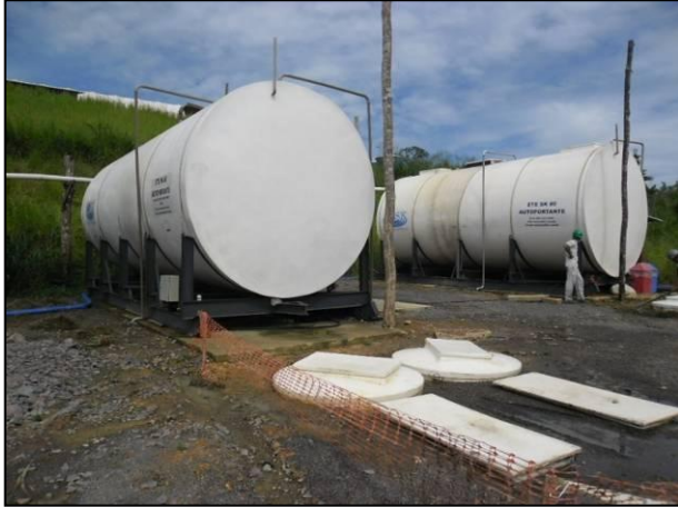
Figura 3.1 - 53 - ETE Sítio Canais e Diques com capacidade nominal de 120 m 3 /dia
