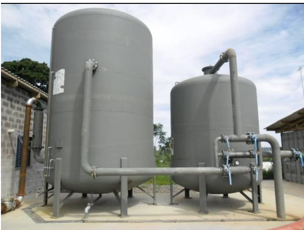
Figura 3.1 - 43 - ETA Sítio Canais e Diques com capacidade de 100 m 3 /hora
