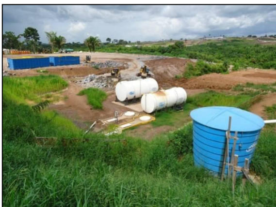
Figura 3.1 - 49 – ETE Sítio Belo Monte com capacidade de 100 m 3 /dia
