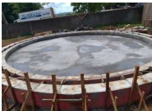
Figura 5.1.9-27 – Base da Nova ETA
