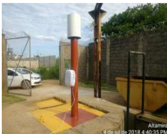
Figura 5.1.9-18 – Queimador de Gás da E.E.E do Panelas
