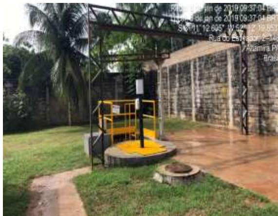
Figura 5.1.9-15 – Estação Elevatória de Esgoto - EEE Mutirão
