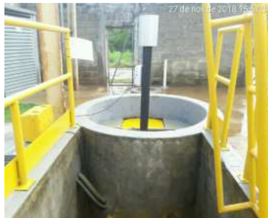
Figura 5.1.9-16 – Estação Elevatória de Esgoto – EEE Coca cola
