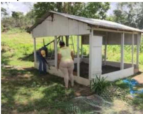
Figura 4.1.5 – 7 – Projeto Produtivo Alternativo – Horta e Criação de Galinha Caipira -construção de aviário - 05/04/2018
