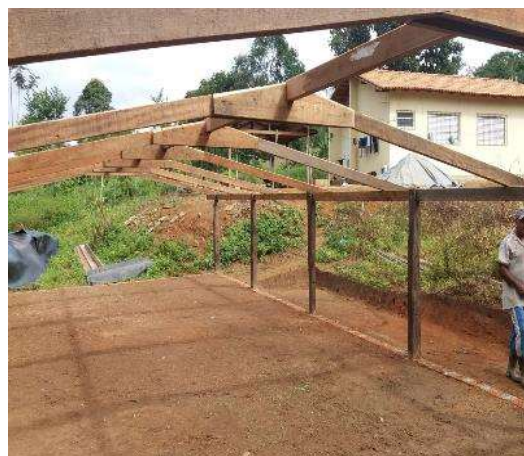
Figura 4.1.5 – 8 – Projeto Produtivo Alternativo – Lavoura Cacaeira – Acompanhamento da construção de barça de alvenaria - 20/05/2018
