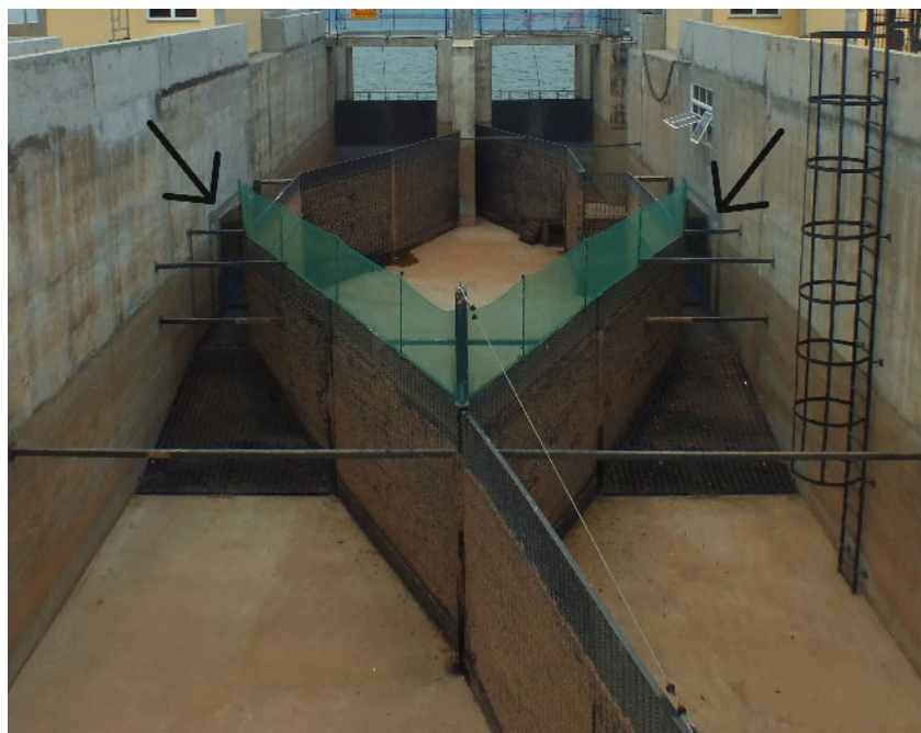
Figura 13.3.6 - 10 – Grades de direcionamento dos peixes no canal de saída. Os dois visores estão assinalados com as setas pretas.
