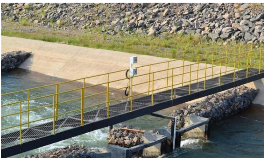
Figura 13.3.6 - 33 – Sensores de profundidade do sistema de monitoramento hidráulico.
