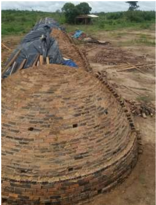
Figura 12.1.2 – 19 - Nove fornos instalados Fonte: Norte Energia (2018)
