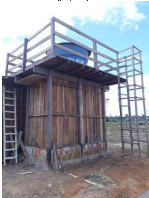
Figura 12.1.2 – 20 - Estrutura de apoio da unidade de conversão Fonte: Norte Energia (2018)
