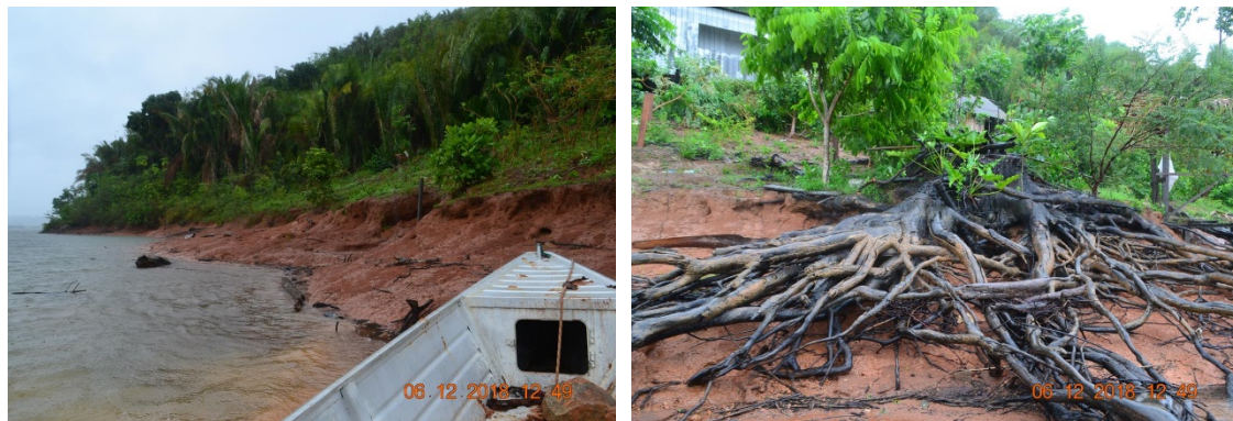
Figura 10.3 - 9 – Aspecto geral da base da encosta com evidências de processos erosivos ativos, onde se observa também raízes de árvores expostas.
