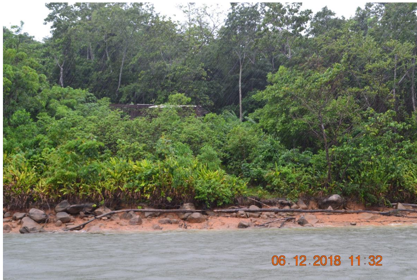
Figura 10.3 - 4 – Aspecto geral do talude do Ponto AMADO (Ponto R56) durante a inspeção de dezembro de 2018.
