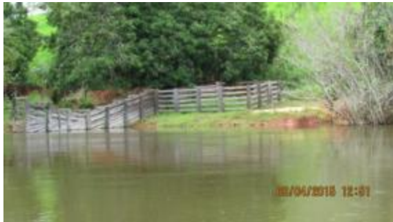
Inspeção Trimestral 13 (abril/2015 - cheia): Área aparentemente estável. Devido ao aumento do nível do rio observa-se a cobertura do talude em relação à vistoria anterior.
