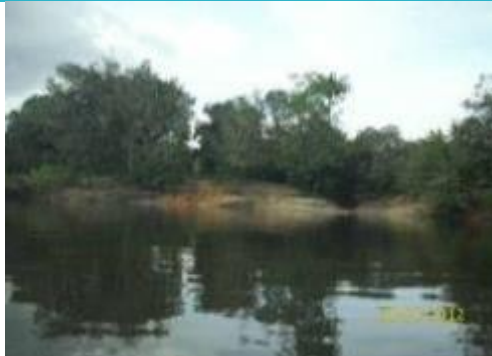
Inspeção Trimestral 1 (maio/2012 - cheia): Margem degradada por ação antrópica e natural. Em alguns pontos, nota-se uma leve erosão laminar associada à ação antrópica, fluvial e pluvial,
