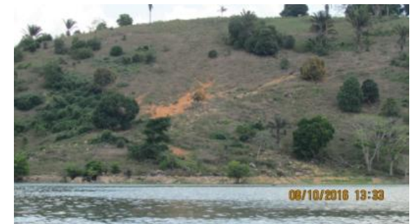
Inspeção trimestral 21 (outubro/2016 - seca): Base do talude exposta devido ao rebaixamento da lâmina de água do reservatório.
