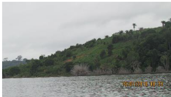
Inspeção trimestral 26 (janeiro/2018 - enchente): Blocos rochosos, na base e no leito do rio, levemente expostos devido ao período de enchente. Processo erosivo causado por pisoteio do gado, aparentemente estável.
