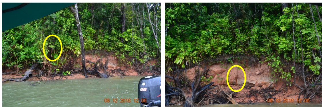
Figura 10.3 - 6 – Detalhe da encosta de solo monitorada, onde se destaca os dois monitores instalados (círculo amarelo).
