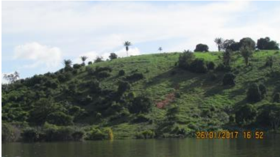
Inspeção trimestral 22 (janeiro/2017 - enchente): Blocos rochosos, na base e no leito do rio, submersos. Processo erosivo causado por pisoteio do gado, aparentemente estável.
