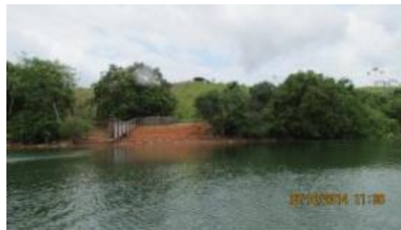
Inspeção Trimestral 11 (outubro/2014 - seca): Área aparentemente estável. Devido ao rebaixamento do nível do rio observa-se maior exposição do talude em relação à vistoria anterior. Pouca diferenciação de características em relação às visitas anteriores em épocas similares.
