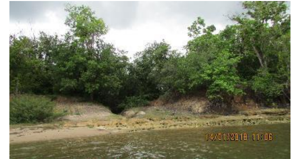
Inspeção trimestral 27 (maio/2018 - cheia): Talude e zona de praia erodidos pelo escoamento superficial derivado da microbacia a montante do rio. Situação similar ao que foi observado em janeiro de 2018. Sem relação com o empreendimento de Belo Monte.
