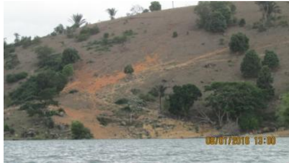
Inspeção trimestral 17 (janeiro/2016 - enchente): Blocos rochosos da base do talude totalmente submersos. Processo erosivo, causado por pisoteio do gado, aparentemente estável.
