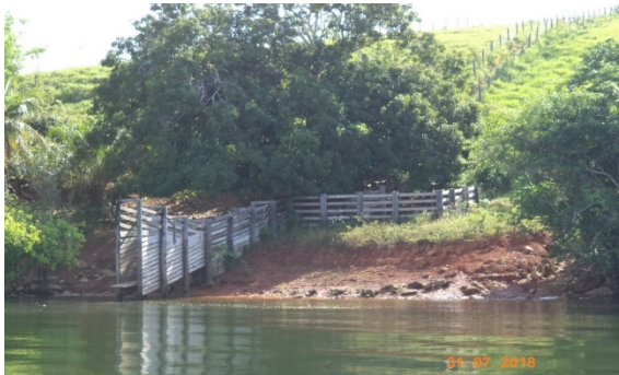
Inspeção trimestral 28 (julho/2018 - vazante): Zona de praia mais exposta devido ao período sazonal de vazante. Aparentemente estável sob o ponto de vista geotécnico.
