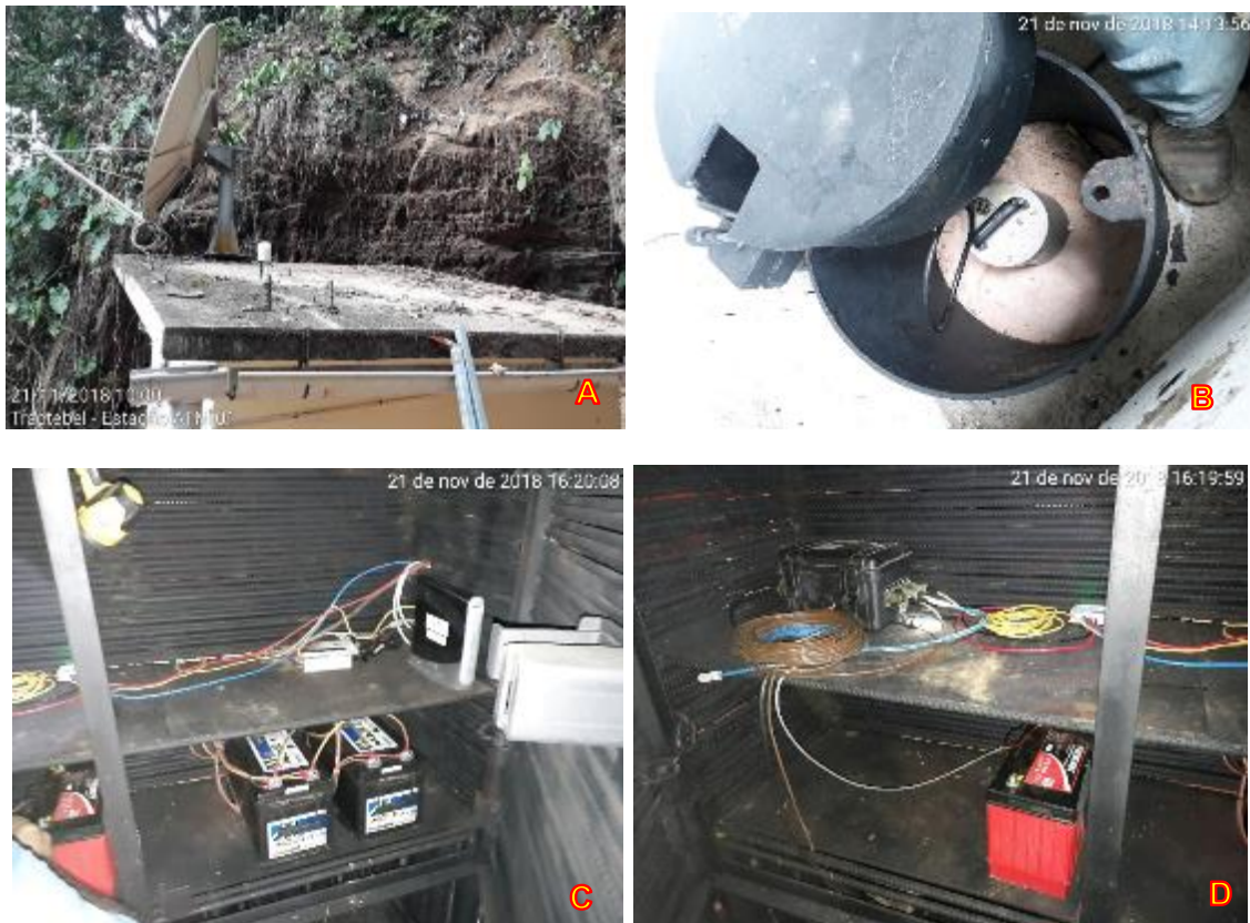
Figura 10.1 - 2 – Aspectos gerais das atividades de reinstalação dos equipamentos da estação ATM 01 (21 de novembro de 2018): (A) Detalhe da antena e GPS instalados sobre a edícula; (B) Detalhe do sismômetro instalado; (C) Detalhe das baterias estacionárias; e (D) Digitalizador e baterias instaladas.
