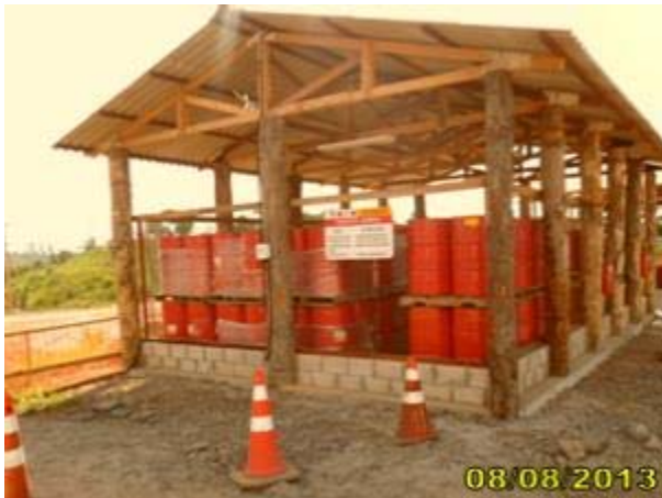
Figura 11: Depósito de produtos químicos, próximo a estrutura da oficina de manutenção. O mesmo disponibilizava de todos os dispositivos de contenção.
