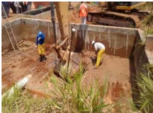
Figura 23: Evidência da remoção dos sólidos que estavam contidos no interior da caixa de acumulação, com apoio de escavadeira hidráulica.
