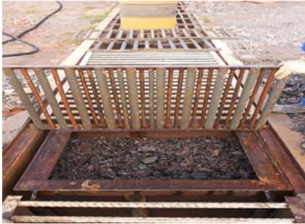
Figura 05: Sistema de dreno com brita, instalado no início da tubulação da canaleta, para evitar acúmulo de sedimentos.
