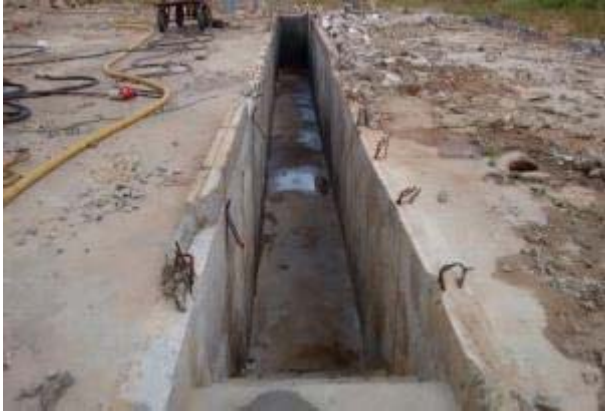
Figura 21: Evidência das canaletas após a realização da lavagem e descontaminação, com início do processo de quebra e perfuração dos pisos.
