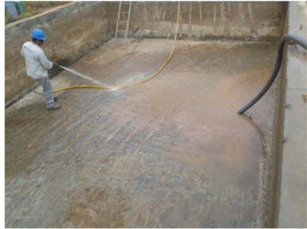
Figura 26: Realização do segundo enxague da estrutura, fazendo o uso da bomba de alta pressão.
