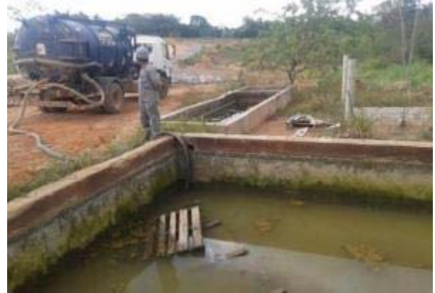
Figura 22: Evidência de sucção do efluente contido no interior da caixa de acumulação, fazendo o uso de caminhão próprio para tal atividade.
