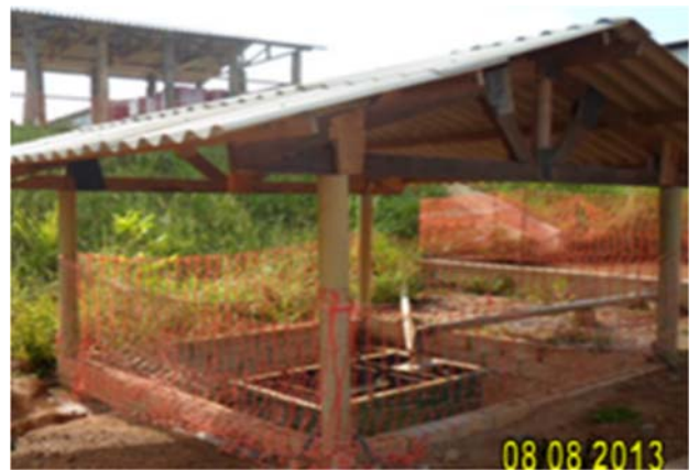
Figura 06: Sistema de tratamento de efluentes industriais, Caixa SAO – Caixa Separadora de Água e Óleo.
