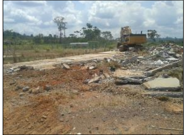
Figura 20: Quebra da estrutura de concreto das estruturas da oficina;
