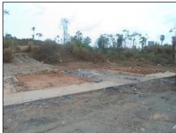
Figura 18: Quebra da estrutura
