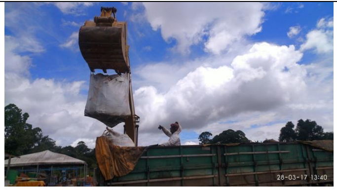
Figura 8 – Data 28.03.2017 – Início da retirada dos resíduos contaminados e destinação para empresa ECOPETRO.
