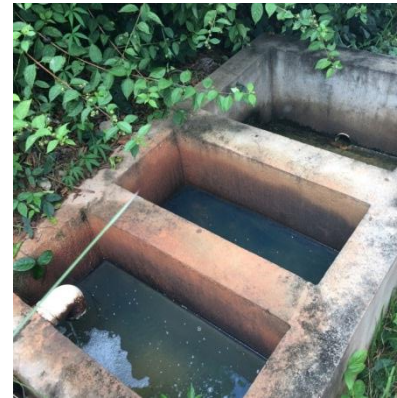
Figura 22: Caixa S.A.O próximo ao canal, após a retirada do óleo.
