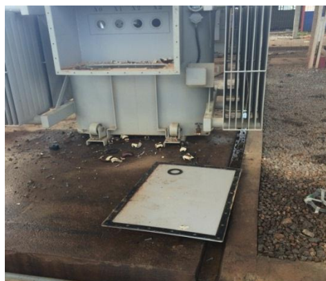
Figura 02– Transformador de elevação danificado, com vazamento de óleo.
