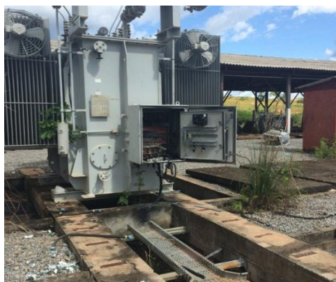
Figura 01: – Transformador de 34,5 kV danificado com vazamento de óleo.
