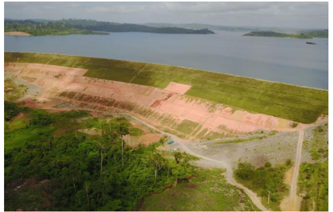
Figura 16: Correção de processos erosivos Dique 8A- BM - Setembro/17
