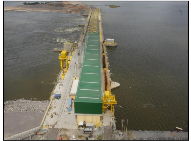
Figura 04 – Visão da área das estruturas definitivas pela Margem Esquerda na unidade de Pimental. Jan/17
