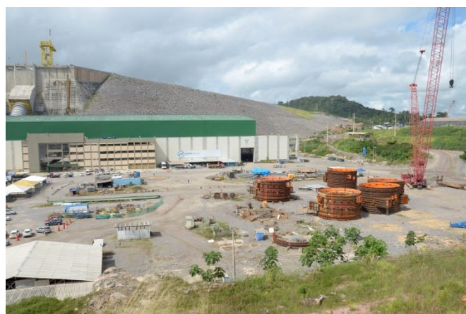
Figura 26 – Vista Casa de Força I e área de Montagem – Sítio Belo Monte – Jun/2017
