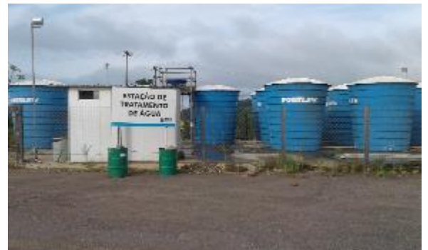
Figura 10: Estação de Tratamento de Água - Fevereiro.
