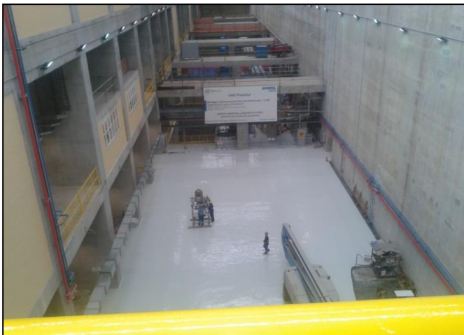
Figura 13: Área interna da Casa de Força da unidade de Pimental em funcionamento. Mar/17..
