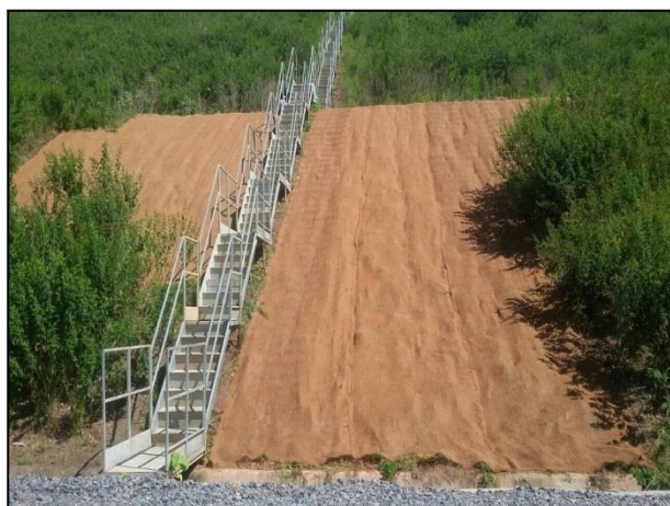
Figura 17: Acompanhamento da construção das escadas dos Diques na unidade de BV. Abr/2017.
