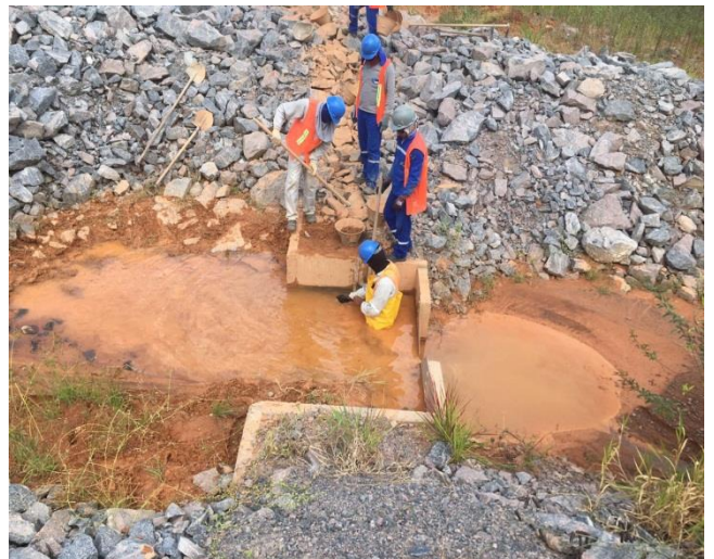
Figura 06: Limpeza de medidores de vazão - Diques – Julho/17
