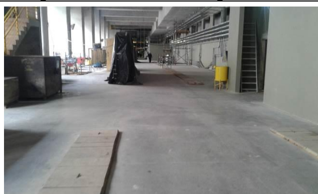
Figura 29: Galeria Elétrica AM – Julho.
