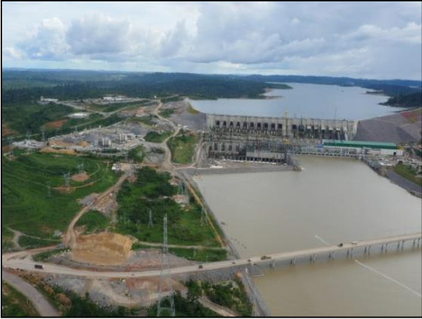
Figura 07: – Visão da área das estruturas definitivas pela Margem Direita do Sítio Belo Monte. Fev/17.
