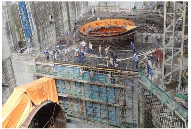
Figura 22: Circuito de Geração Unidades de Geração 09 a 18– Mai/2017
