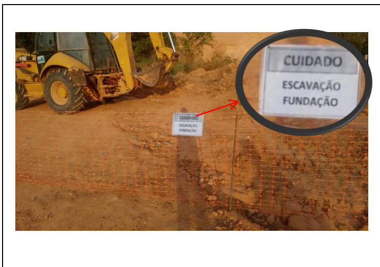
Figura 01 – Sinalização orientativas de cuidado – Outubro/17
