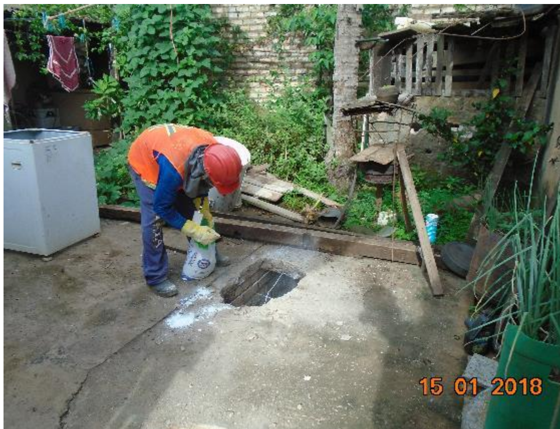
Figura 5.1.9 - 22 – Limpeza e desinfecção de fossa séptica
