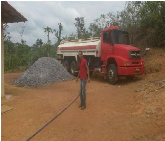
Figura 4.2.1 – 65 - abastecimento de água – 11/12/2017
