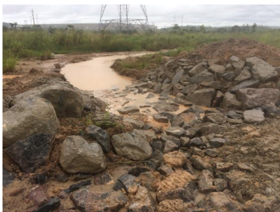
Figura 3.2-15 – Canaleta de direcionamento do fluxo d'água no BF-04 – Sítio Belo Monte
