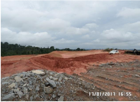
Figura 3.2 - 17 – Sistema de drenagem na AE-3A – Sítio Pimental
