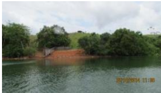
Inspeção Trimestral 11 (outubro/2014 - seca): Área aparentemente estável. Devido ao rebaixamento do nível do rio, observa-se maior exposição do talude em relação à vistoria anterior. Pouca diferenciação de características em relação às visitas anteriores em épocas similares.
