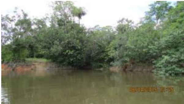
Inspeção Trimestral 13 (abril/2015 - cheia). Área aparentemente estável. Menor exposição do talude e desaparecimento da zona de praia.
