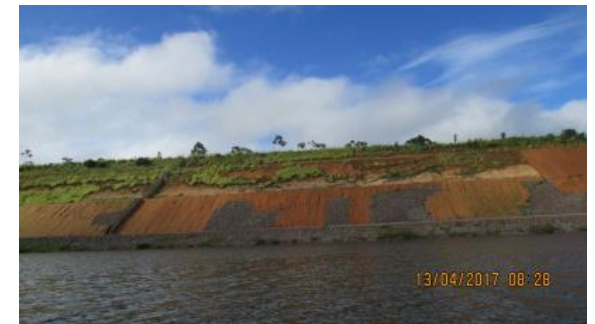
Inspeção trimestral 23 (abril/2017 - cheia): Na maioria das porções com solo exposto foi colocada biomanta. Ponto ainda sujeito à erodibilidade e ravinamento, devendo continuar a ser monitorado.
