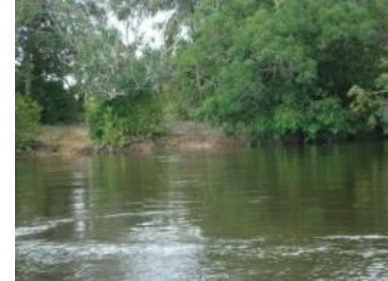
Inspeção Trimestral 9 (abril/2014 - cheia): Área potencialmente estável. Menor exposição do talude e da zona de praia devido à elevação do nível do rio Xingu.
