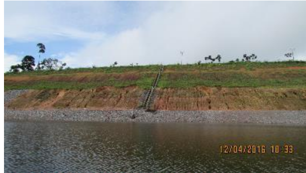
Inspeção Trimestral 19 (abril/2016 - vazante): Ponto no Canal de Derivação; nos locais sem vegetação se observa sulcos erosivos. Alguns sulcos/erosões foram preenchidos com cascalho.
