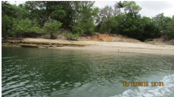
Inspeção 16 (dezembro/2015 - enchente): Talude e zona de praia expostos devido ao baixo nível do rio. Processo erosivo ativo na continuação do canal a montante do rio devido ao escoamento superficial da microbacia de montante.
