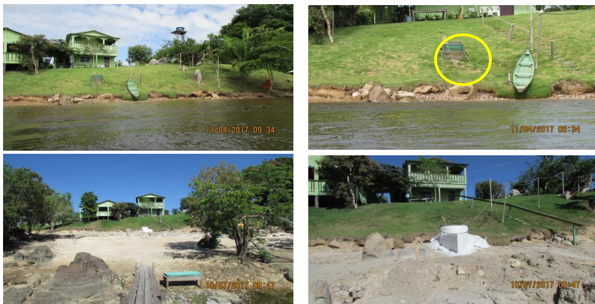
Figura 10.3 - 5 - TVR1. Desenvolvimento de erosão do tipo piping devido à ação das ondas. A cisterna cadastrada TVR1 (coordenadas UTM 392865/9618170) foi danificada devido à ação das ondas, porém foi reinstalada pela Norte Energia.
