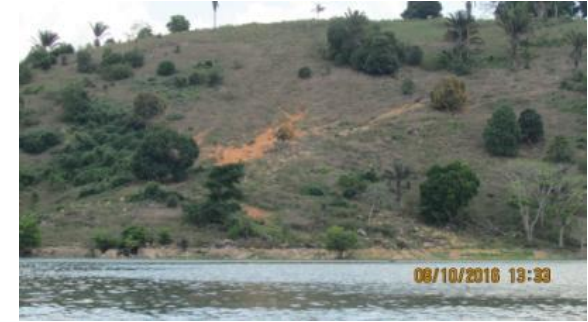
Inspeção trimestral 21 (outubro/2016 - seca): Base do talude exposta devido ao rebaixamento da lâmina de água do reservatório.
