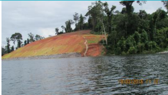
Inspeção Trimestral 18 (fevereiro/2016 - enchente): Novo ponto cadastrado após o enchimento do reservatório. Quatro taludes com rampas em processo de revegetação. Em alguns pontos se nota a presença de sulcos erosivos.
