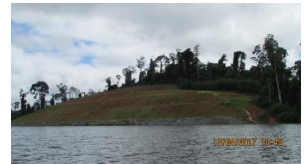
Inspeção trimestral 23 (abril/2017 - cheia): Estes cortes de estruturas fixas estão no contexto da Construção/ Engenharia e não no PRAD. Apesar da maior densidade de gramíneas nos taludes, ações mitigadoras se fazem necessárias: sugere-se preenchimento de eventuais sulcos abertos no talude e revegetação superficial. Ponto sujeito à continuidade do monitoramento.
