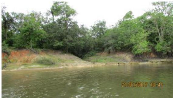
Inspeção trimestral 22 (janeiro/2017 - enchente): Talude e zona de praia erodidos pelo escoamento superficial derivado da microbacia a montante do rio. Processo ativo na continuação do canal a montante do rio, em função do escoamento superficial da microbacia de montante. Sem relação com o empreendimento de Belo Monte.
