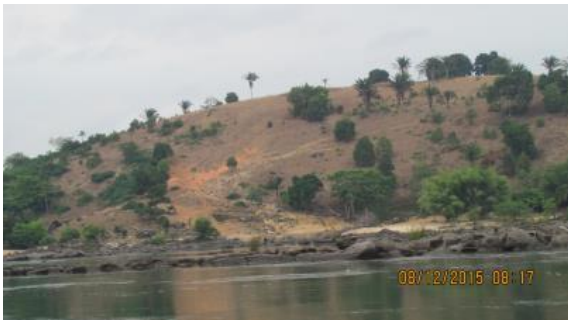
Inspeção 16 (dezembro/2015 - enchente): Exposição dos blocos rochosos na base do talude e no leito do rio. Processo erosivo causado por pisoteio do gado, aparentemente estável.
