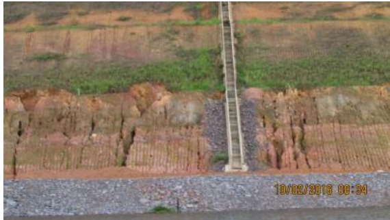
Inspeção Trimestral 18 (fevereiro/2016 - enchente): Novo ponto cadastrado após o enchimento do reservatório (Km 9,5 do Canal de Derivação); sulcos erosivos ao longo de todo o talude.
