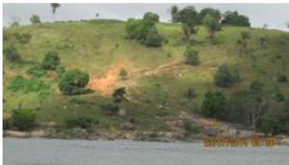
Inspeção Trimestral 10 (julho/2014 - cheia): Área potencialmente estável. Nota-se leve diminuição da vegetação na encosta e maior exposição das rochas próximas à margem do rio Xingu, devido ao rebaixamento de seu nível.
