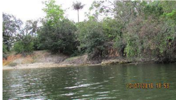
Inspeção trimestral 20 (julho/2016 - vazante): Talude e zona de praia erodidos pelo escoamento superficial derivado da microbacia a montante do rio. Processo estagnado na continuação do canal a montante do rio, pois não há escoamento superficial da microbacia de montante. Sem relação com a UHE Belo Monte.
