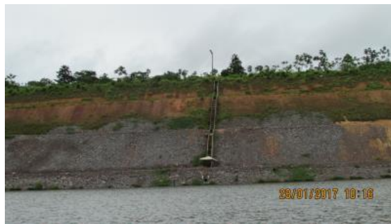
Inspeção trimestral 22 (janeiro/2017 - enchente): Os locais com sulcos erosivos foram enrocados. Continuar o monitoramento para avaliação da eficácia da solução de engenharia empregada.
