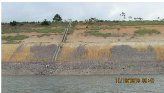
Inspeção trimestral 21 (outubro/2016 - seca): Os locais com sulcos erosivos foram enrocados. O monitoramento do ponto deverá ser feito para se avaliar a evolução e eventual continuidade ou não dos processos erosivos.
