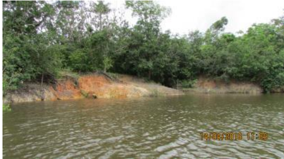
Inspeção trimestral 19 (abril/2016 - cheia): Zona de praia submersa devido ao aumento da lâmina de água. Processo erosivo ativo na continuação do canal a montante do rio devido ao escoamento superficial, durante as chuvas, da microbacia de montante. Região sob observação.
