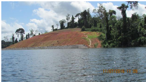
Inspeção trimestral 21 (outubro/2016 - seca): Taludes do canal de transposição CTCA; parte da área submersa e talude com base enrocadas, em processo de revegetação. Onde o solo está exposto já são observados sulcos erosivos. A continuidade do monitoramento nesta região se faz necessária para se avaliar a efetividade da obra realizada com fins de mitigação.
