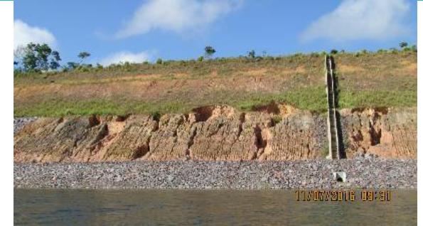
Inspeção trimestral 20 (julho/2016 - vazante): Sulcos erosivos ao longo de todo o talude, nos locais sem vegetação. Alguns sulcos foram preenchidos com cascalho. Região em franco desenvolvimento e aceleração dos processos erosivos. Medidas mitigadoras de engenharia se fazem necessárias.
