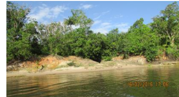
Inspeção 18 (fevereiro/2016 - enchente): Talude e zona de praia erodidos pelo escoamento superficial derivado da microbacia a montante do rio. Processo erosivo ativo na continuação do canal a montante do rio devido ao escoamento superficial da microbacia de montante.
