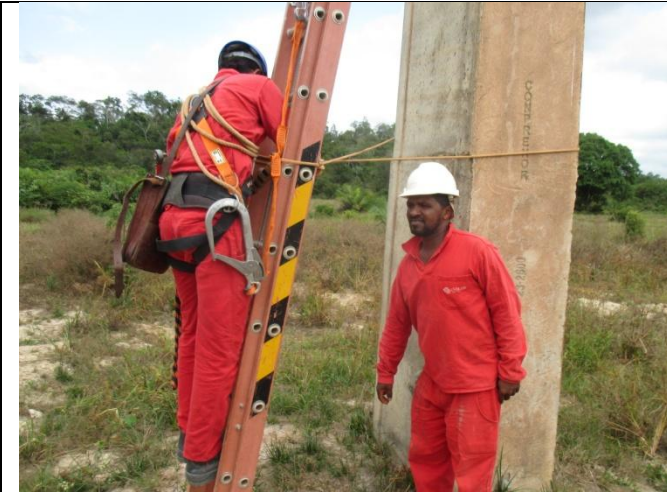
Foto 05- Inspeções trabalho em altura, amarração de escada de acesso.
