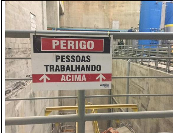
Figura 05 – Sinalização de segurança
