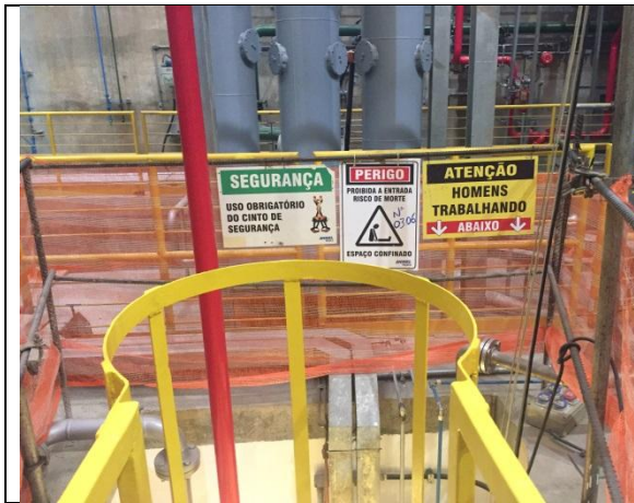
Figura 01 – Sinalização de segurança
