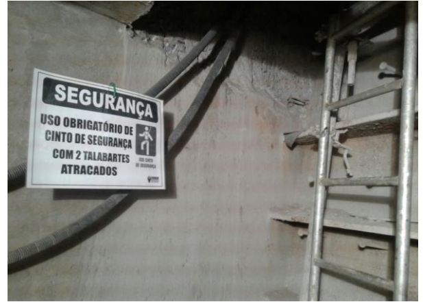
Figura 8: Sinalização de Segurança
