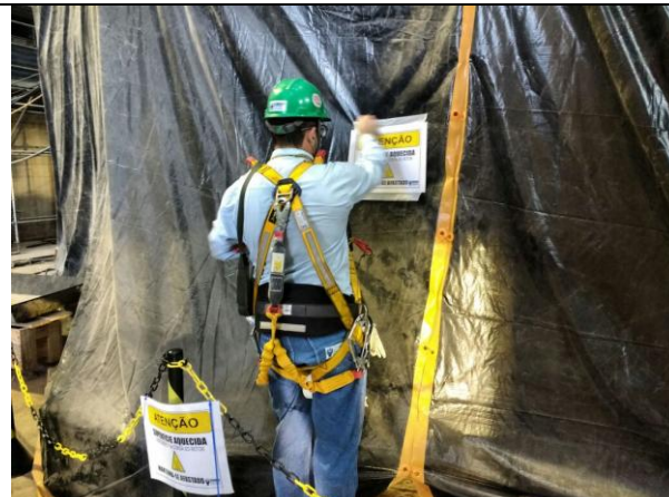
Figura 6: Sinalização de Segurança
