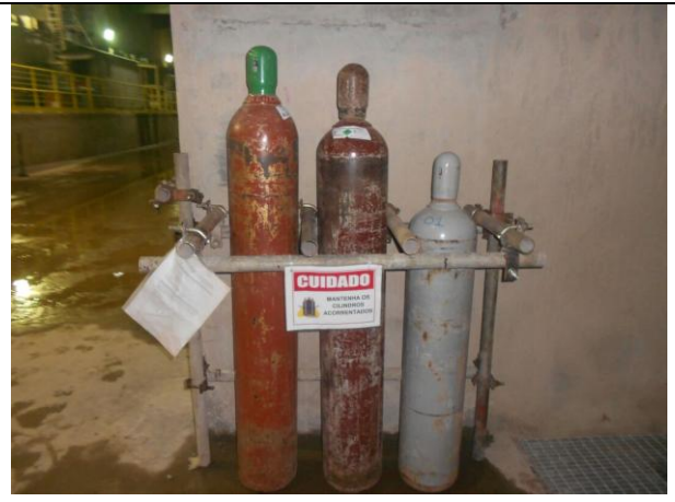
Figura 12: Sinalização de Segurança
