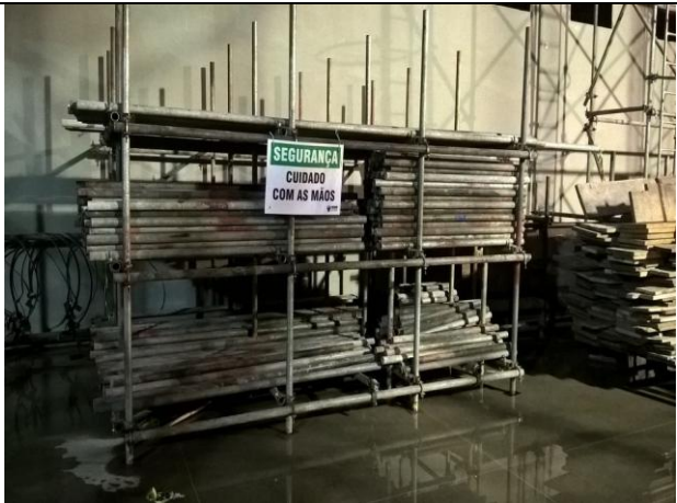
Figura 11: Sinalização de Segurança
