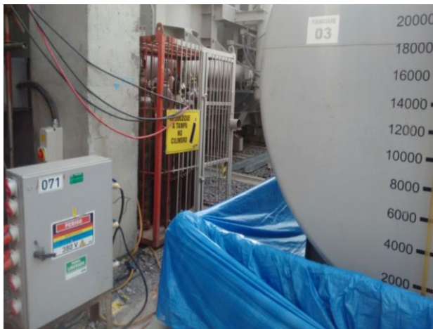
Figura 3: Sinalização de Segurança
