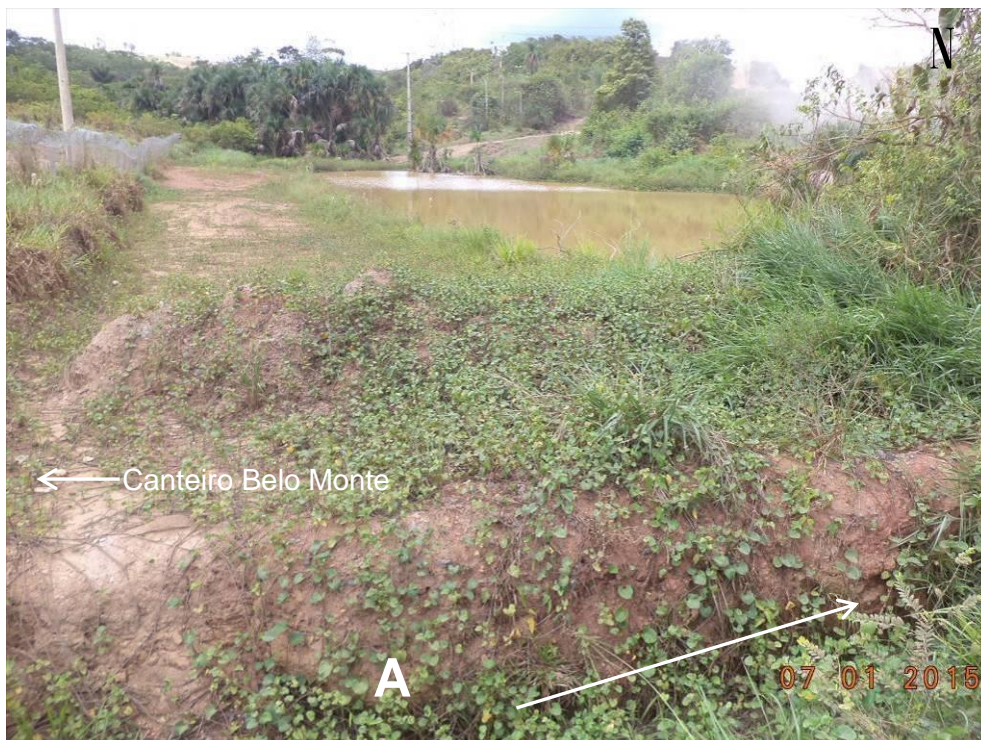
Foto - 2 – Detalhe da canaleta (A) construída para escoar a água das chuvas acumuladas no canteiro pioneiro Belo Monte em janeiro de 2015.
