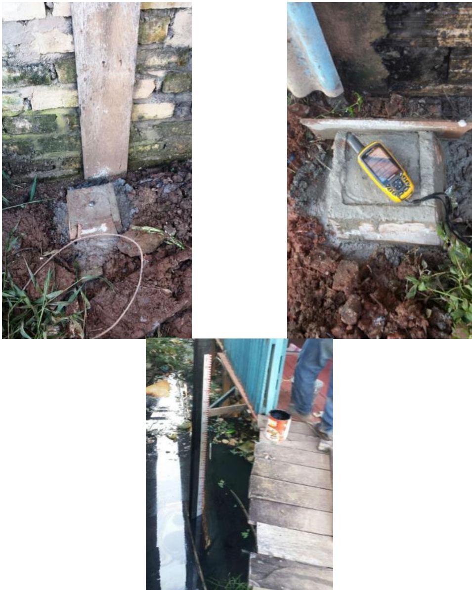
Figura 11.3.1 - 32 – Registro fotográfico da instalação da régua linimétrica pela empresa HXR em 06/06/2016.
