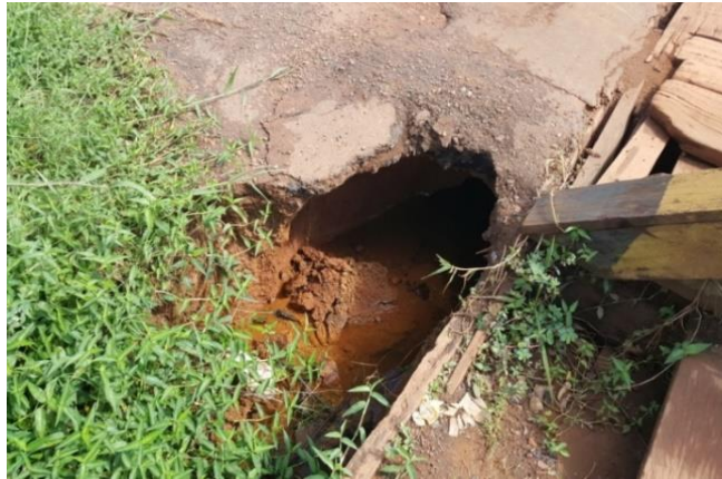
Figura 5 - Detalhe do encontro do aterro e Ponte de madeira – condição atual. Notar erosão.
