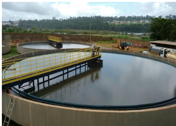
Figura 16 - Operação da ETE – Altamira – Tanques
