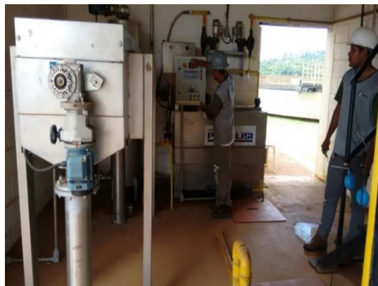
Figura 15 - Operação da ETE – Altamira – sala de tratamento químico
