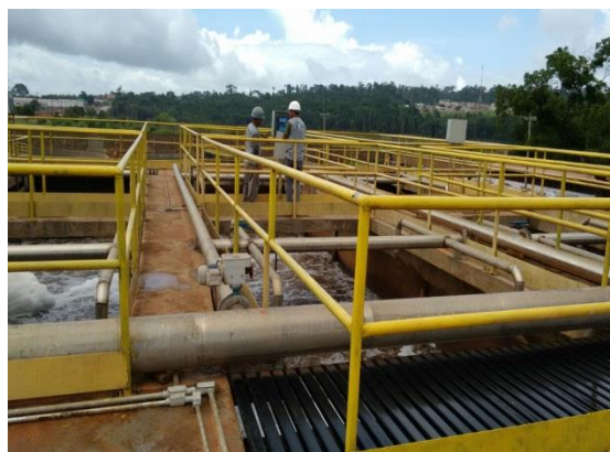
Figura 13 - Operação da ETE – Altamira - MBBR e medidores OD
