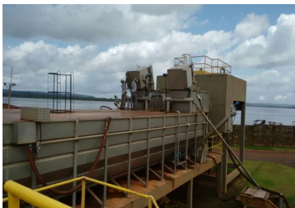
Figura 12 - Operação da ETE – Altamira - Combi
