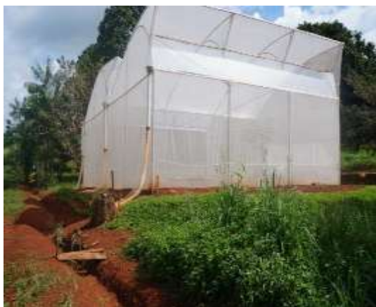
Figura 4.2.1 - 10– Instalação de Estufa - Área Externa
