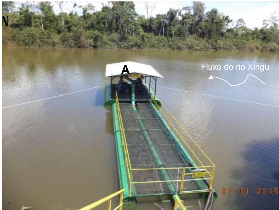
Foto - 1 – Vista da área do ponto de captação de água bruta para o canteiro Belo Monte, no rio Xingu. Em detalhe, a bomba de captação (A).
