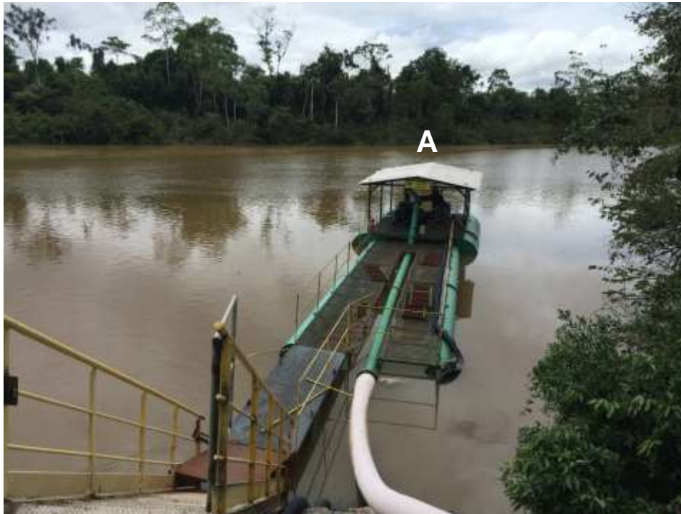
Foto - 3 – Vista da área do ponto de captação de água bruta para o canteiro Belo Monte, no rio Xingu, em abril de 2016. Em detalhe, a bomba de captação (A).
