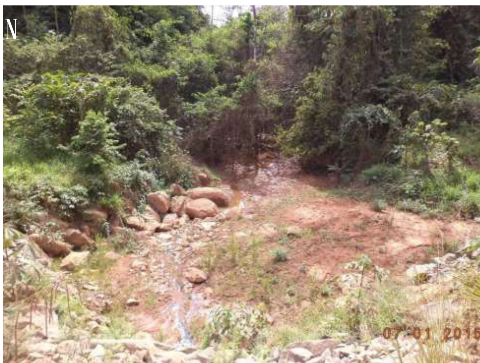
Foto - 2 - Vista geral do igarapé Santo Antônio a montante do canteiro Belo Monte, constatando a reduzida vazão do igarapé, provavelmente pela pouca pluviosidade na região, haja vista que não foram identificadas intervenções provenientes das obras.
