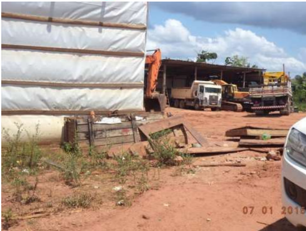
Foto - 1 – Detalhe da oficina mecânica instalada próximo ao igarapé Santa Helena. Vale ressaltar que essa oficina é de propriedade particular não havendo contrato do Consórcio Construtor com a mesma.
