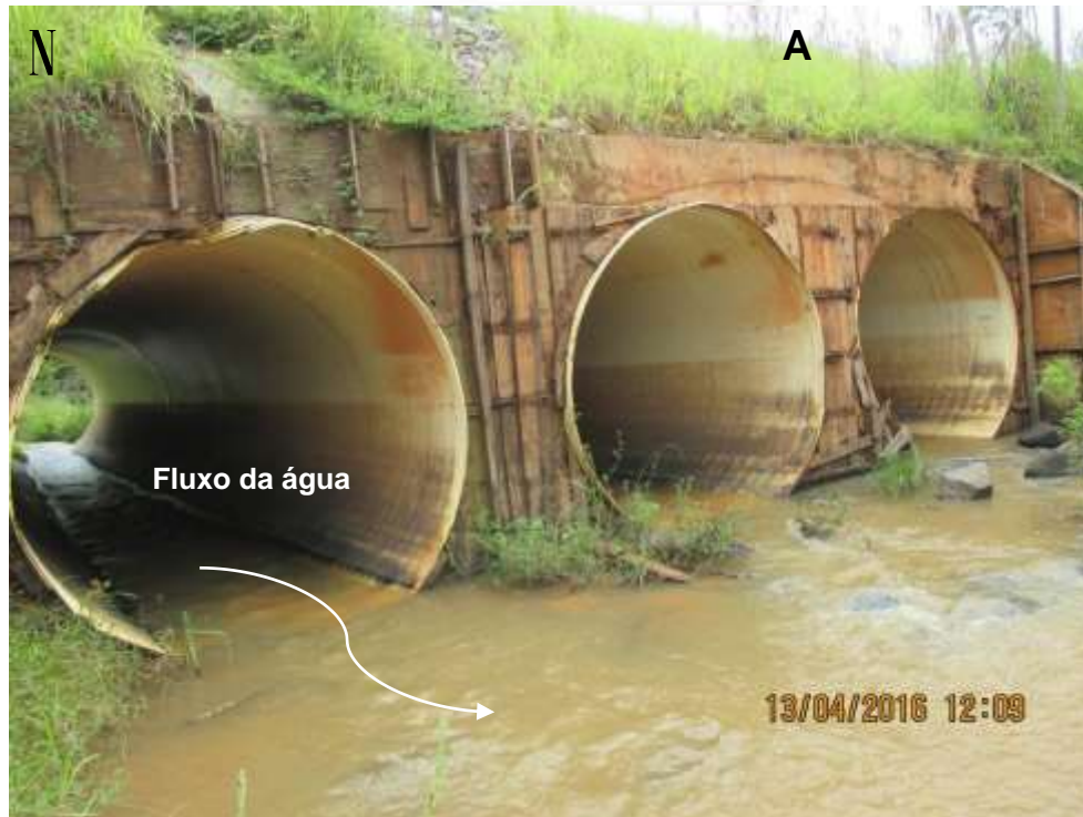
Foto - 1 – Vista do igarapé Paquiçamba a jusante do Travessão km 55 (A) e a jusante do dique 28.
