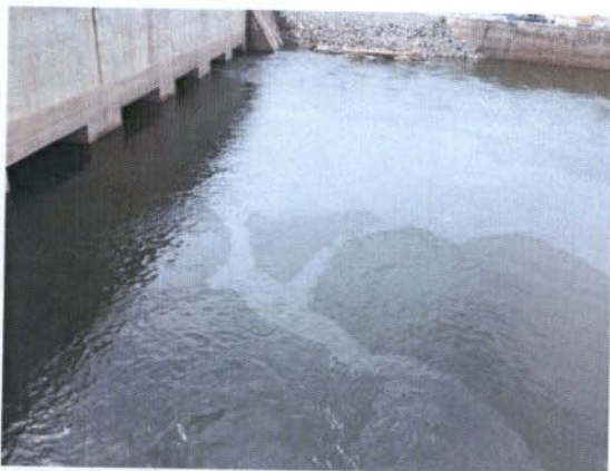
Figura 1 – Detecção do óleo no corpo hídrico próximo ao canal de fuga da Casa de Força Complementar
