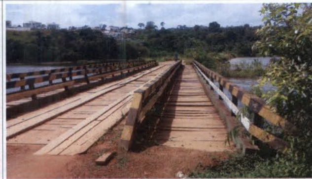
Foto 6 – Ponte de madeira sobre o igarapé Ambé ainda não retirada pela NE por falta de autorização da prefeitura.
