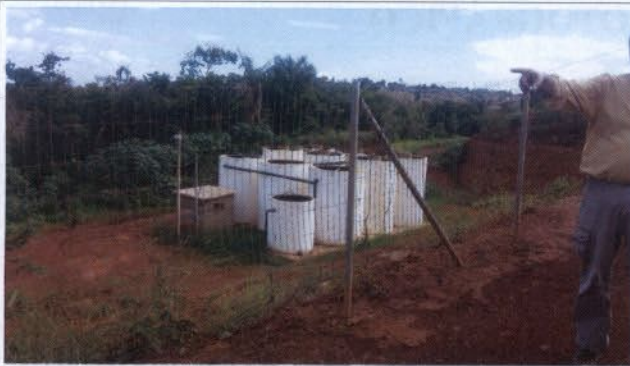
Foto 9 – ETE compacta do RUC São Joaquim ainda em operação.
