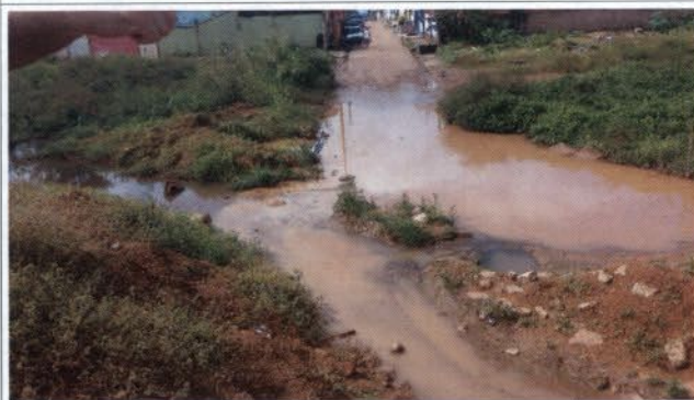
Foto 5 – Problema de drenagem de água pluvial identificado no parque igarapé Altamira.
