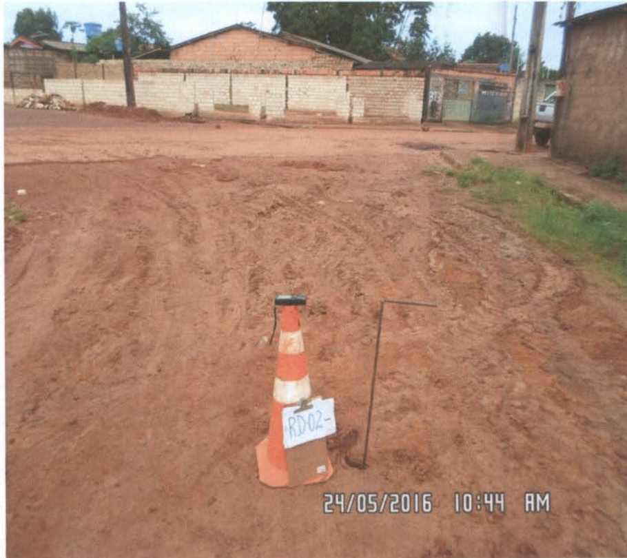
Figura 16: REGISTRO DE DESCARGA RD-02
