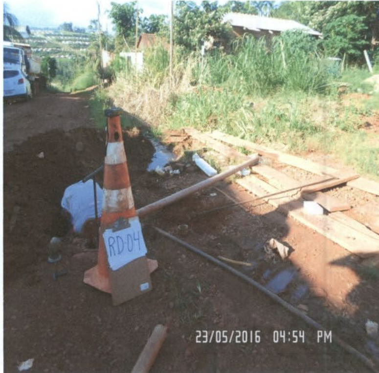
Figura 24: REGISTRO DE DESCARGA - RD 04
