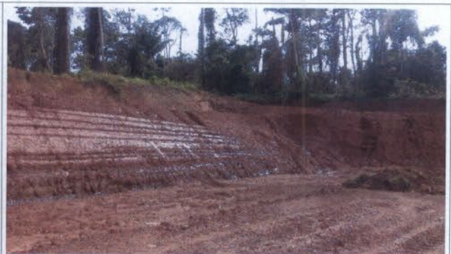
Foto 10 – Situação dos taludes do RUC Laranjeiras.
