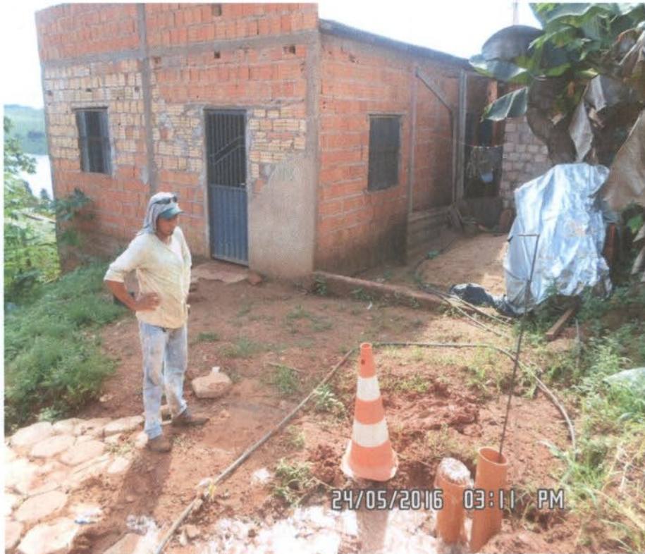
Figura 18: REGISTRO DE DESCARGA RD-3
