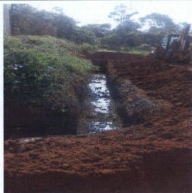
Foto 7 – Calha sendo escavada no entorno da elevatória do RUC Jatobá para o caso de extravasamento de esgoto.
