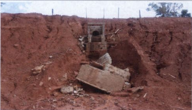
Foto 13 – Sistema de drenagem de água pluvial destruído pelas chuvas no RUC Laranjeiras.
