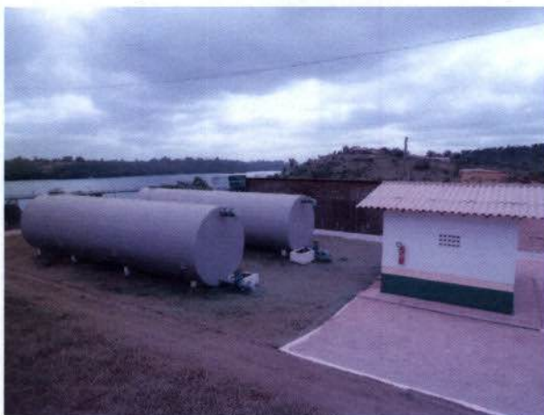
Foto 01: Vista do sistema de saneamento implantado Comunidade de Belo Monte
