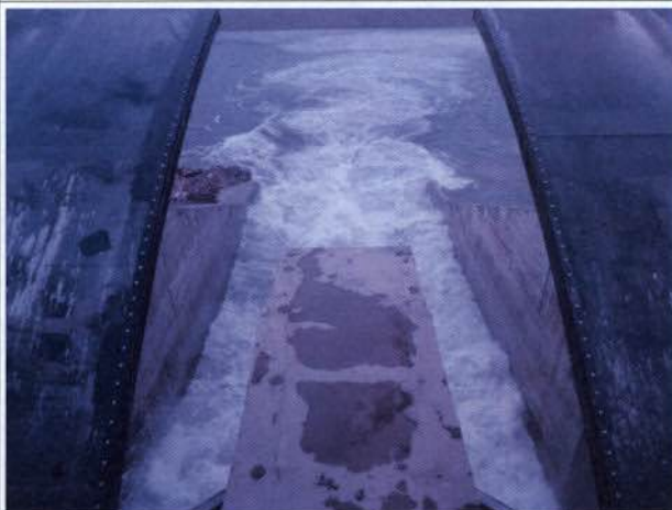
Foto 30: Vertedouro de controle de enchimento do canal.
