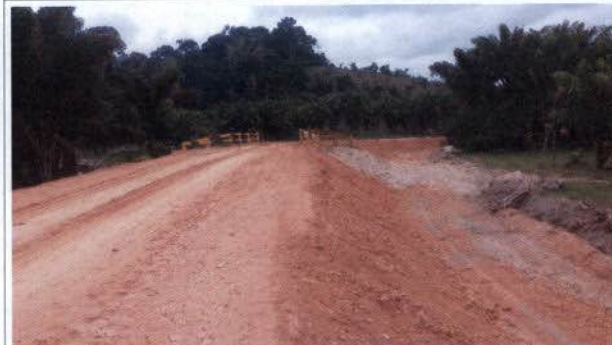
Foto 5 – Acesso recomposto no Setor Palhal Grande (alteamento da via e instalação de ponte de madeira).
