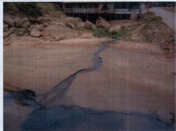
Foto 10 – Esgoto da localidade de Belo Monte do Pontal escorrendo até encontrar o rio Xingu – esta localidade possui rede de esgotamento sanitário e ETE.
