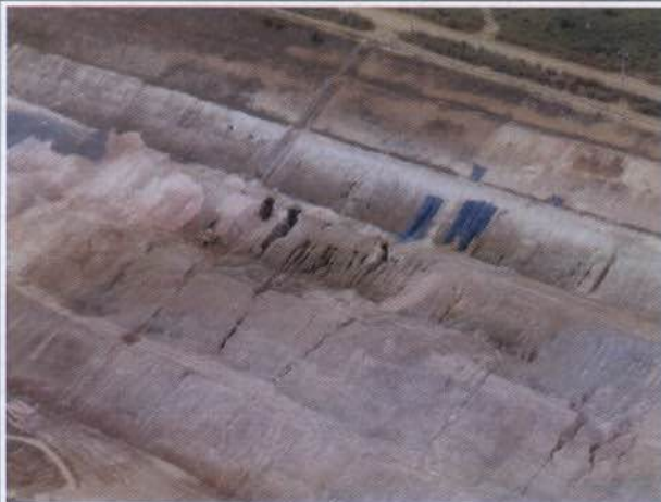
Foto 7: Fissuras no canal de derivação ainda não enrocado com rochas.
