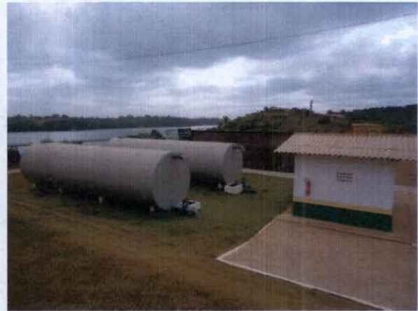
Foto 8 – Estação de tratamento de água (captação superficial) em Belo Monte.
