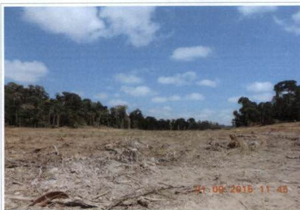
Foto 1 – Área de supressão em fase de conclusão (margem direita do futuro reservatório Xingu).
