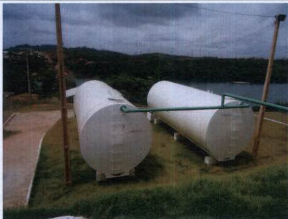
Foto 9 – Estação de tratamento de água (captação superficial) em Belo Monte do Pontal.
