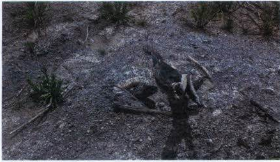
Foto 12: Enterrio de resíduos grossos que deveriam ter sido enterrados e compactados para evitar contato entre material e a água.
