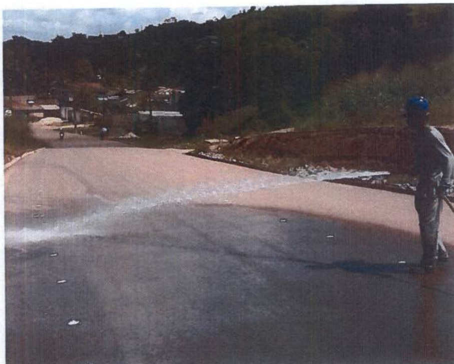
Figura 3 - Limpeza da pavimentação para pintura da pista, (lado Belo Monte do Pontal).
