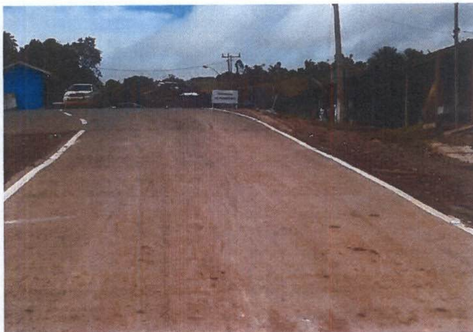
Figura 11 - Sinalização horizontal (faixas e tachas) e sinalização vertical (Placa de travessia de pedestre) - lado Belo Monte.
