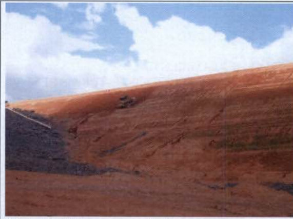
Foto 7 – Dique com talude em recuperação.
