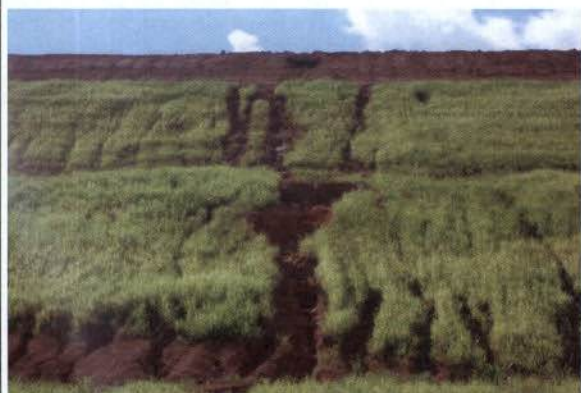
Foto 5 – Sulcos erosivos presentes na maioria dos diques.
