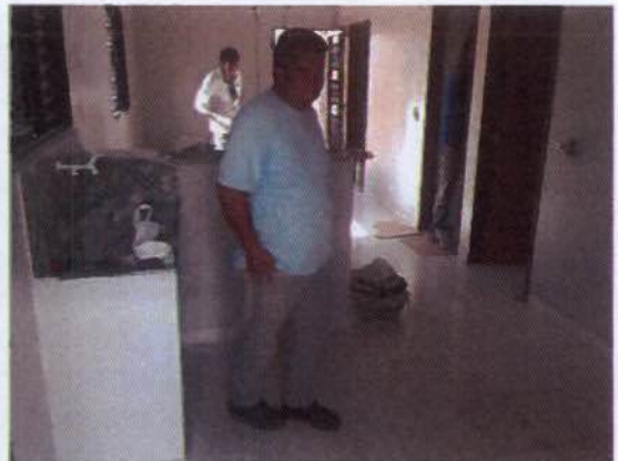
Foto 02 – Construção da moradia de Pedro Benjô Cardoso no Povoado de Belo Monte
