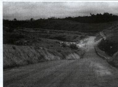
Foto 6 – Trecho do Travessão 50 que precisa passar por processo de recuperação.
