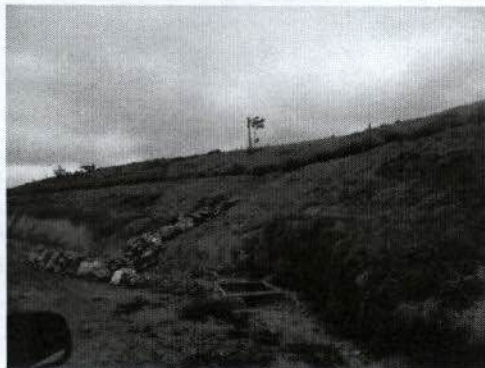
Foto 5 – Trecho do Travessão 50 que precisa passar por processo de recuperação.
