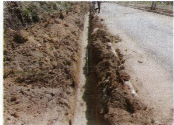
Figura 4 – Tubulação colocada na vala escavada e preparada, formando a rede de distribuição.
