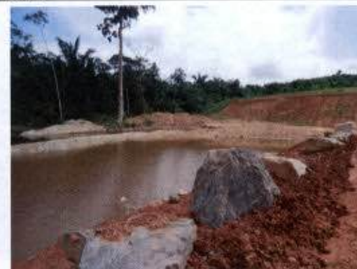
Foto 60 – Alteração do curso d'água do Igarapé Ticaruca – região de construção do Dique 19B.
