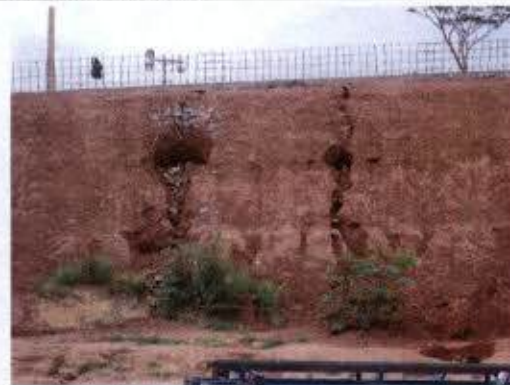
Foto 44 – Ravinamento nos taludes do Sistema de Transposição de Embarcações.
