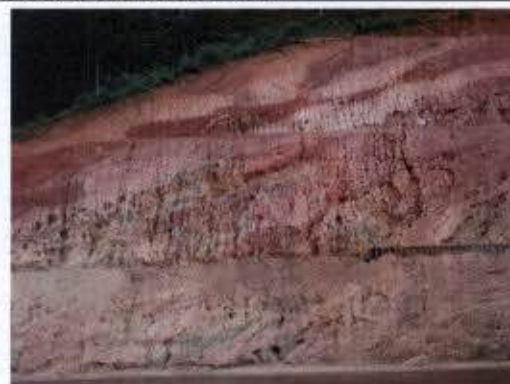
Foto 46 – Ravinamento nos taludes do STE.
