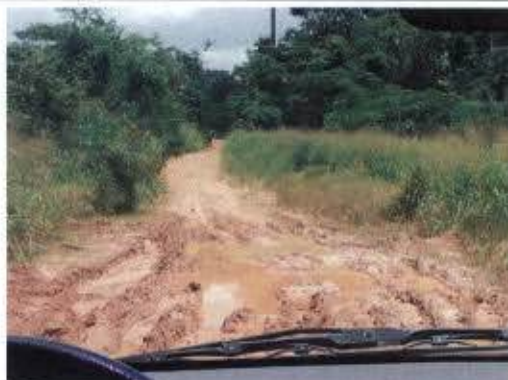
Foto 38 – Acesso ao Dique 8A interditado por atoleiros.
