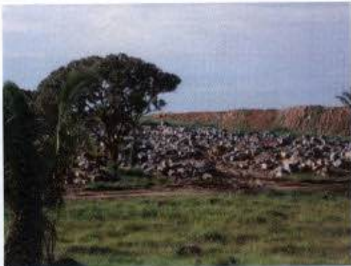
Foto 55 – Material sendo lançado em área que não passou por processo de supressão de vegetação – Bota-fora BF4 do sítio construtivo Belo Monte.
