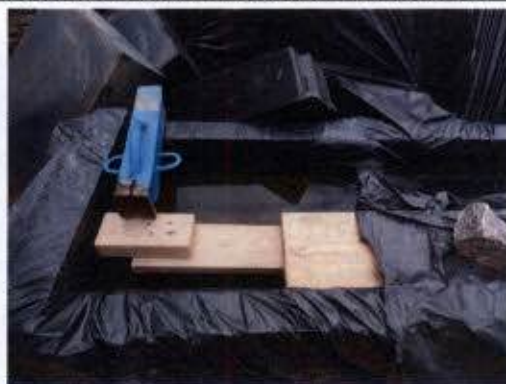
Foto 45 – Acúmulo de água em materiais de obras do STE, podendo causar aumento de casos de doenças transmitidas por vetores nos canteiros.
