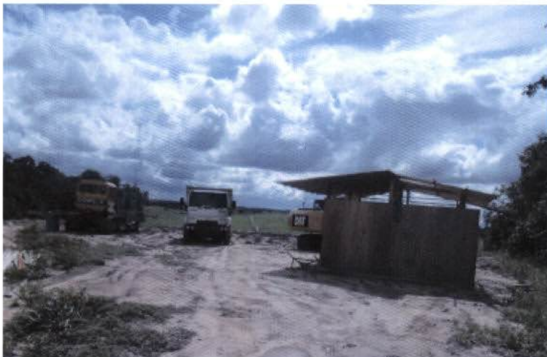
Figura 1 - Infraestrutura e equipamentos mobilizados para viabilizar o início de operação da primeira célula do aterro sanitário de Vitória do Xingu
