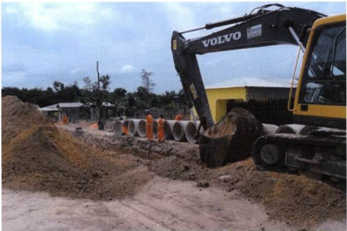
Figura 1 – Abertura das valas para o assentamento das tubulações na sede de Vitória do Xingu
