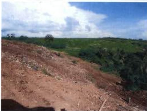
Foto 15 – Solo misturado com resíduos sendo movimentado por um trator da prefeitura para dentro de um vale localizado em frente ao lixão de Altamira.
