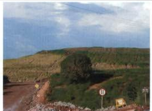
Foto 54 – Uma das faces do Bota-fora BF3 do sítio construtivo Belo Monte – inúmeras ravinas causadas pela ausência de um sistema de drenagem pluvial.
