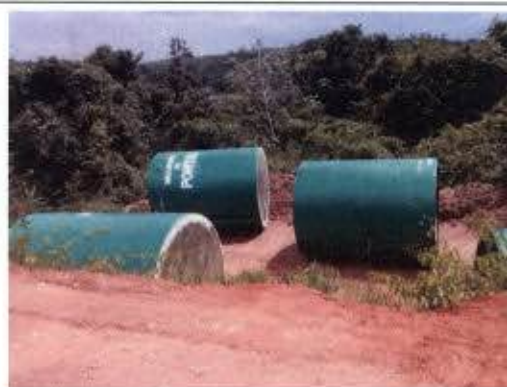
Foto 2 – Tanques da ETE compacta em Belo Monte do Pontal, Anapu.
