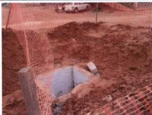
Foto 7 – Poço de visita (PV) em rua de Leonardo da Vinci.
