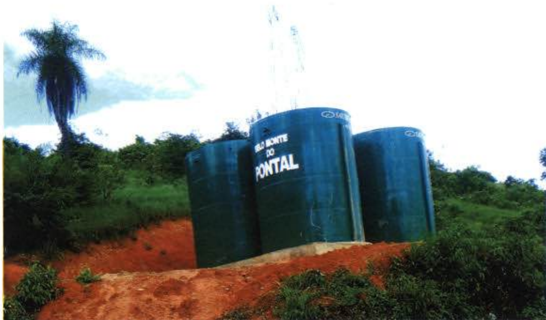
Figura 9 - Tanques dispostos da ETE Belo Monte do Pontal (Anapu)
