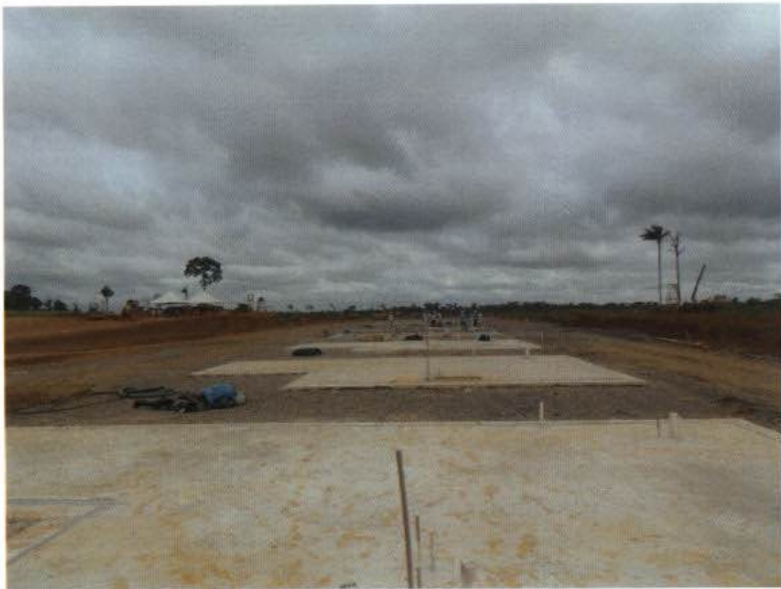
Figura 3 – Implantação das obras para a vila residencial dos trabalhadores em Altamira – Radiers executados
