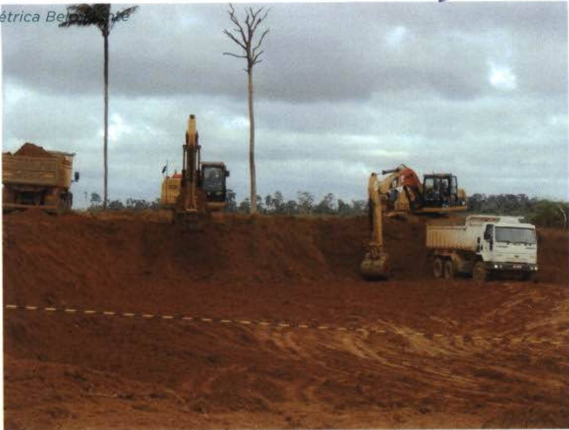
Figura 2 – Implantação das obras para a vila residencial dos trabalhadores em Altamira - Terraplenagem
