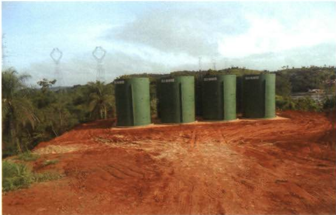
Figura 8 - Tanques dispostos da ETE Belo Monte - Vitória do Xingu
