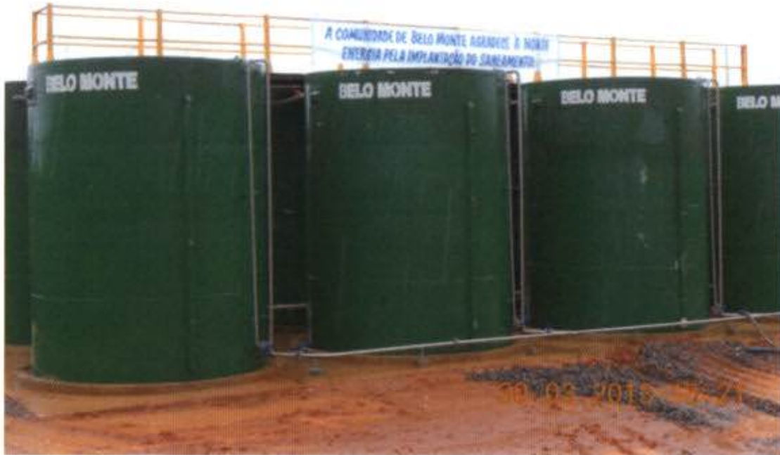
Figuras 7 - Tanques dispostos da ETE Belo Monte – município de Vitória do Xingu
