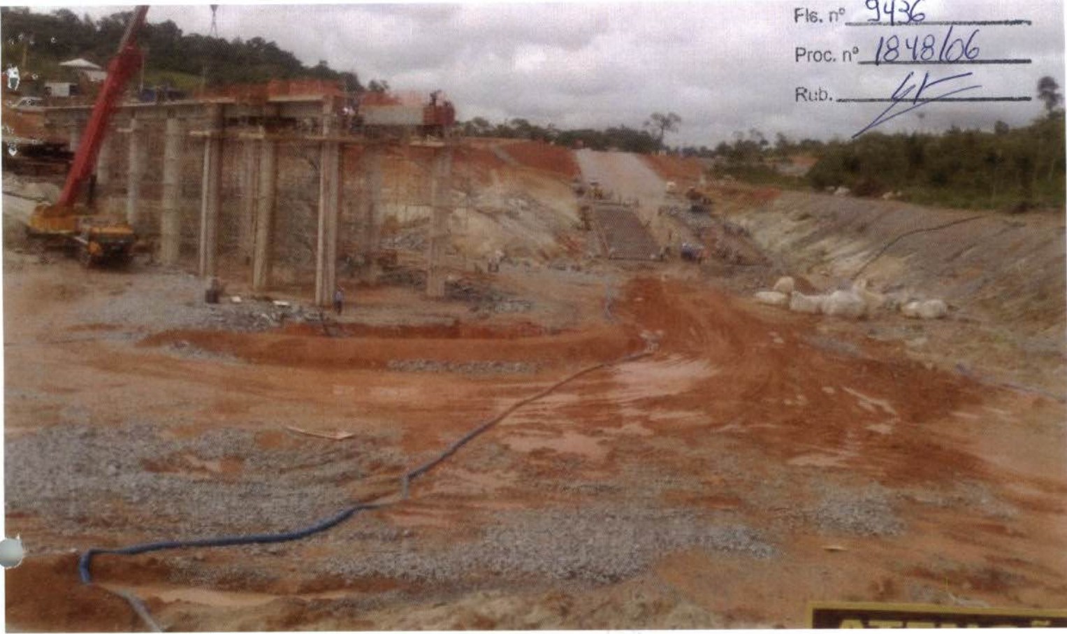
Vista do píer de montante, ao lado esquerdo a preparação para concretagem da rampa para pequenas embarcações
