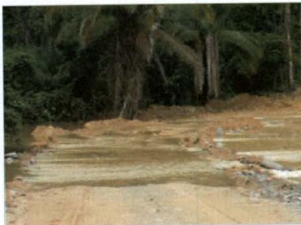
Foto 19. Estrada de acesso ao igarapé 14, com água do igarapé anterior ao mesmo transbordando sobre trecho do leito do mesmo aterrado para construção de vias de acesso do sítio Canais.
