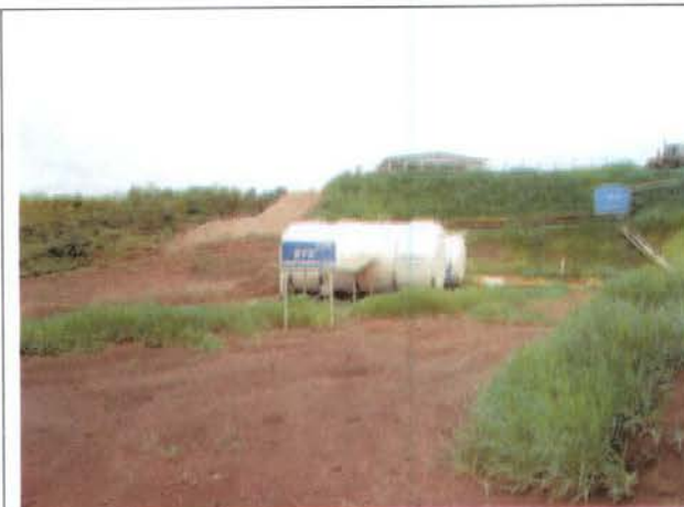
Foto 1 – ETE compacta instalada no sítio construtivo Belo Monte.
