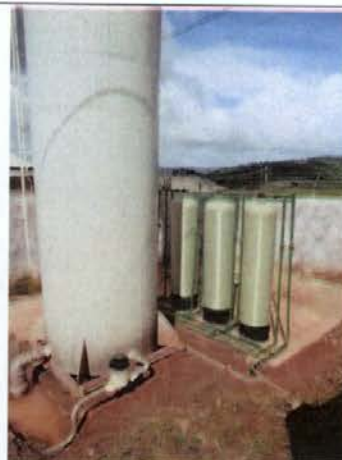
Foto 8 – Filtros especiais (tanques contendo zoólitos) instalados junto ao Reservatório 1 na localidade de Belo Monte.
