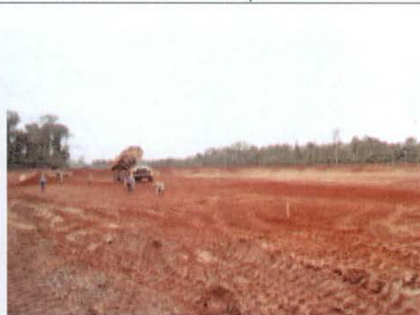
Foto 20 – Local onde será implantada a ETE definitiva do sítio Canal de Derivação – fase de terraplenagem.
