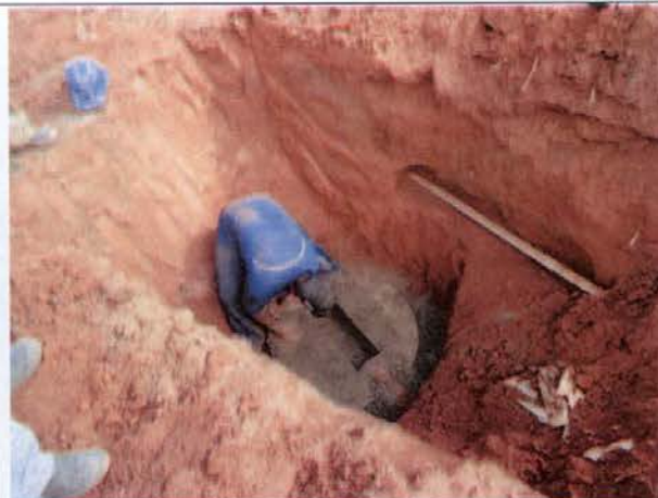
Foto 30 – Instalação de um poço de visita – sistema de esgotamento sanitário em Belo Monte do Pontal.
