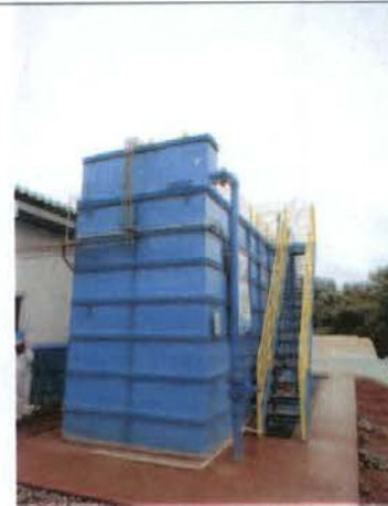
Foto 2 – ETA compacta instalada no sítio Construtivo Belo Monte.
