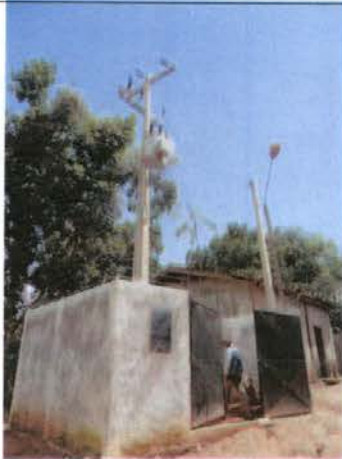
Foto 25 – Local onde está instalado poço profundo (Poço 1) em Belo Monte do Pontal – proteção sanitária.
