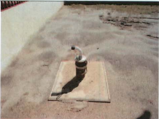
Foto 27 – Segundo poço tubular recém perfurado pela Norte Energia para compor o sistema de abastecimento de água da localidade de Belo Monte do Pontal.
