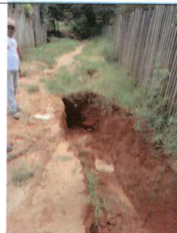
Foto 26 – Erosão causada por águas pluviais em área onde já foi instalada a rede de esgoto em Belo Monte do Pontal.
