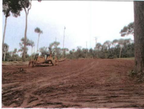
Foto 23 – Local onde será implantado o aterro sanitário do sítio Pimental – fase de retirada do solo vegetal.
