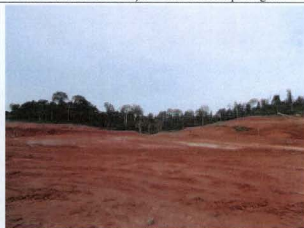
Foto 22 – Local onde será implantada a ETE definitiva do sítio Pimental – fase de terraplenagem.
