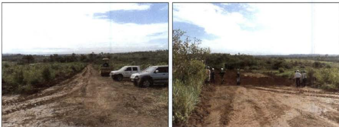
Figura 10 e 11 - Área de Instalações Iniciais após Supressão Vegetal Coordenada UTM: Zona 22M 9654618,232 / 411437,088
