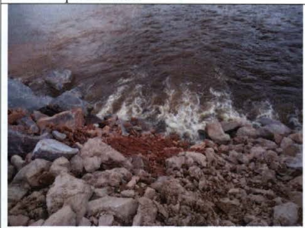
Foto 37 – Percolação da água de montante para a jusante na base do acesso as ilhas.
