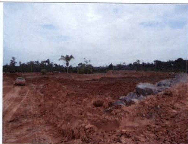
Foto 65 - Área da poligonal do Bota-fora 18 nas margens do futuro Canal de Derivação.
