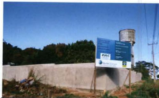
Poço Semi-artesiano Km 18 - situação em 24.05.2011
