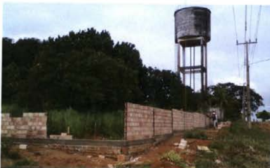
Poço Semi-artesiano Km 18 - situação em 05.04.2011
