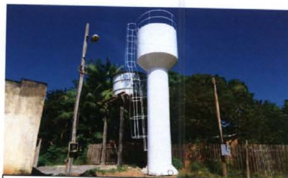
Poço Semi-artesiano Escola Santa Helena - situação em 24.05.2011
