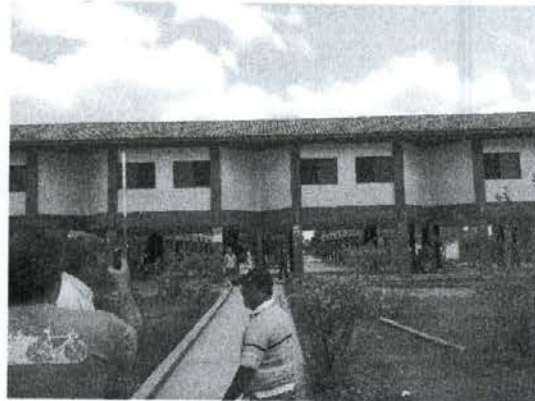
EMEF Irmã Terezinha, reforma não iniciada.
