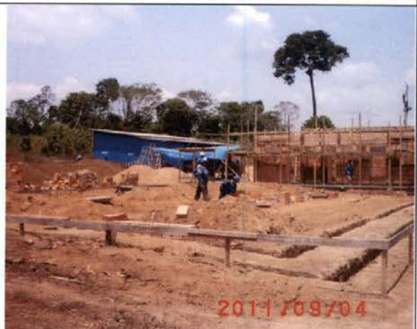
Foto 9. Vista parcial da área de alojamentos, laboratório e câmara fria do viveiro florestal, ainda em construção.
