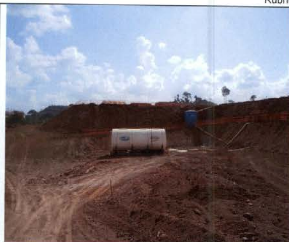
Foto 24. Estação de Tratamento de Esgoto provisória para atender o acampamento pioneiro do Sítio Belo Monte.
