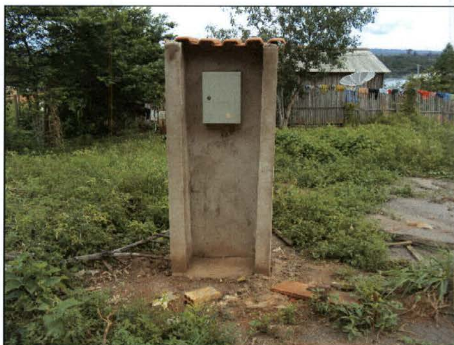
Figura 19 – Caixa de força do poço (ligamento/desligamento da bomba).
