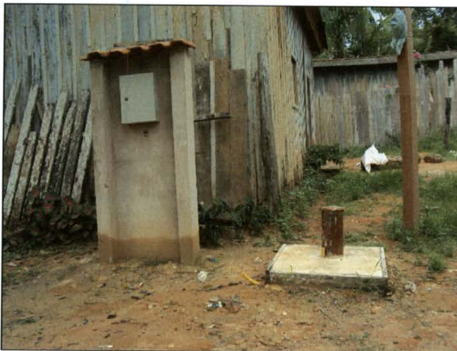
Figura 22 – Vista geral da localização do poço tubular profundo na vila de Belo Monte do Pontal.
